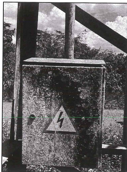
TỦ ĐIỆN CHỚP TUẦN TỰ THUỘC TỪNG DÂY
