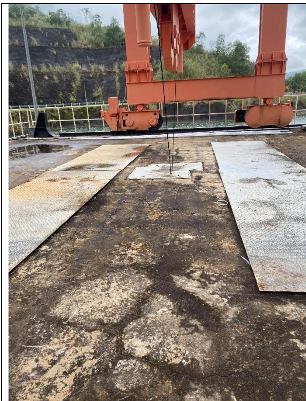
Nứt bê tông bản mặt của nhận nước
