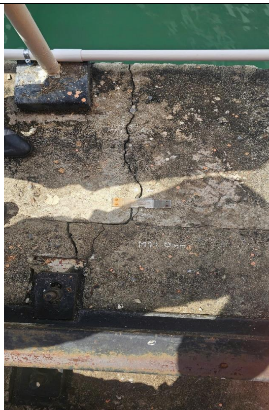
Nứt bê tông bản mặt của lấy nước
