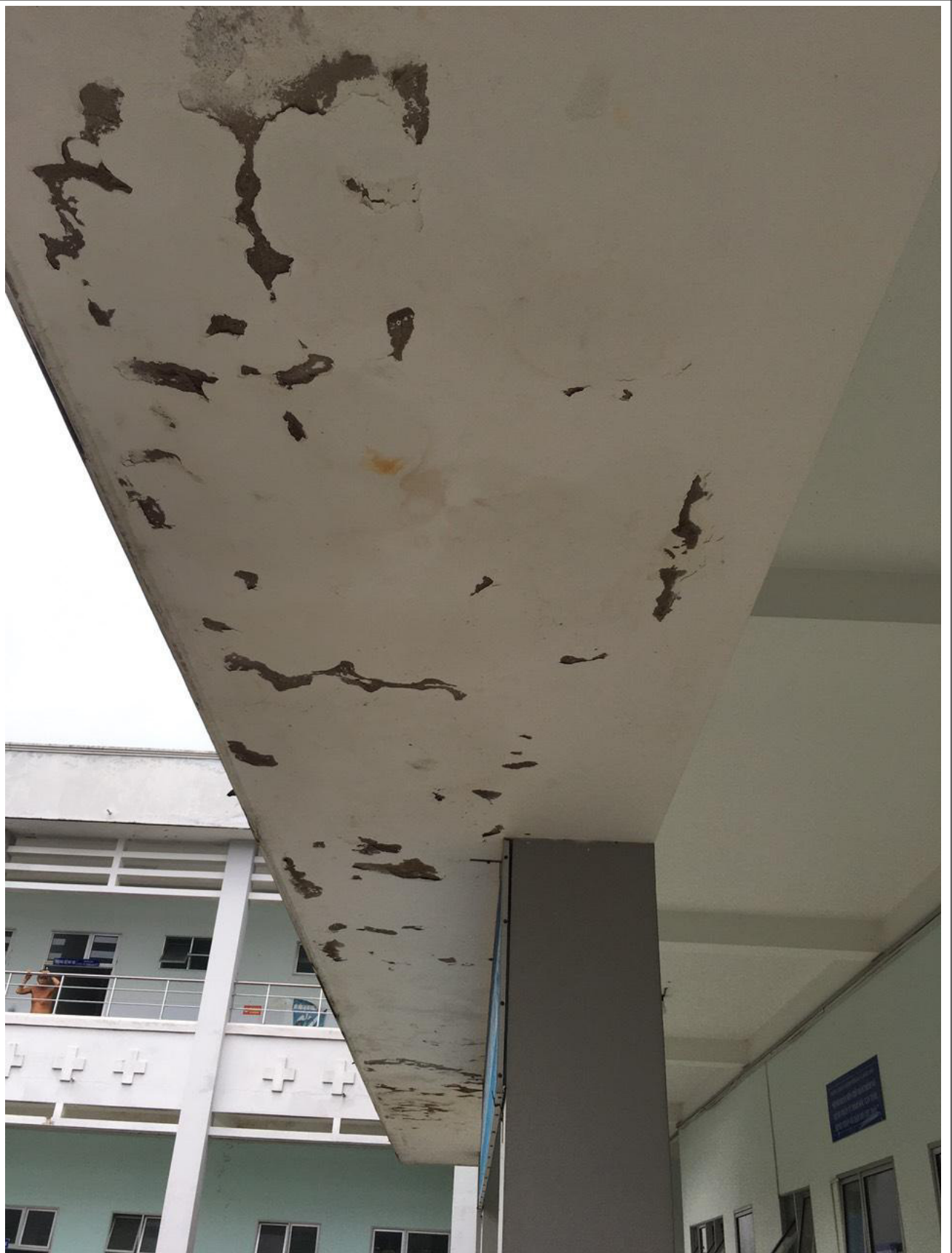
Sàn sênô mái bị thấm
