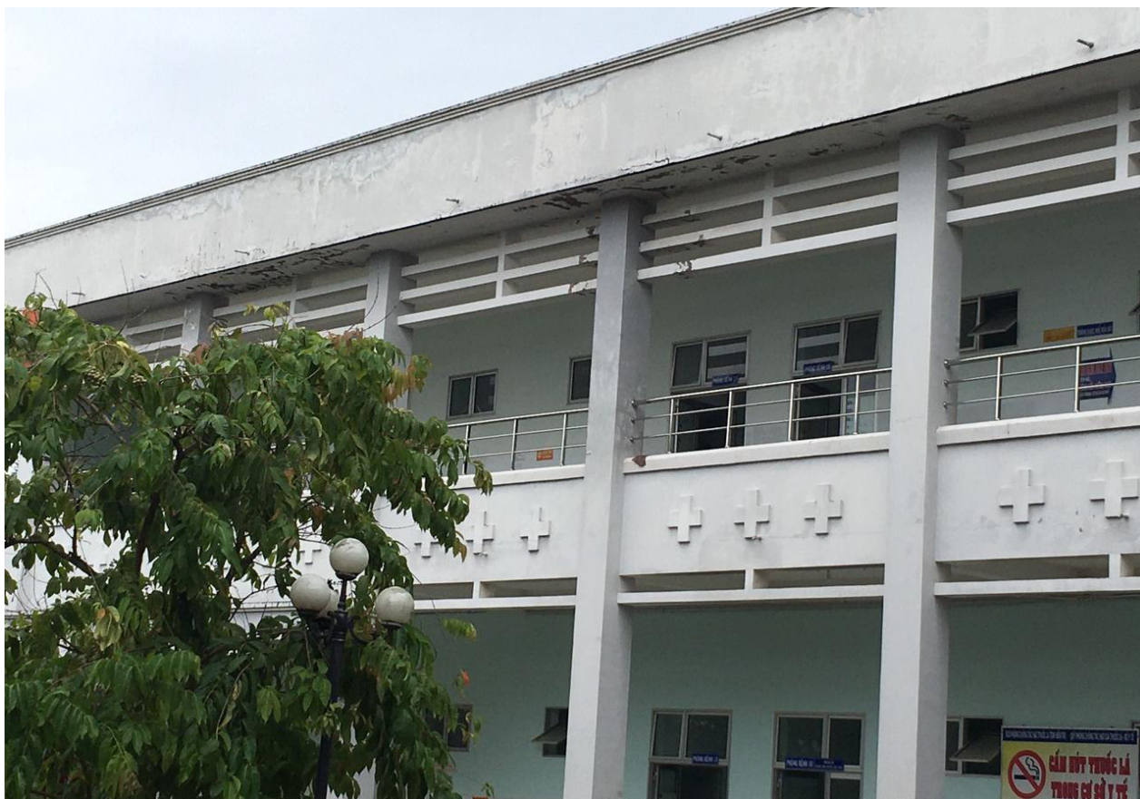
Tường bị bong tróc, ẩm mốc – sàn sân ô mái bị thấm
