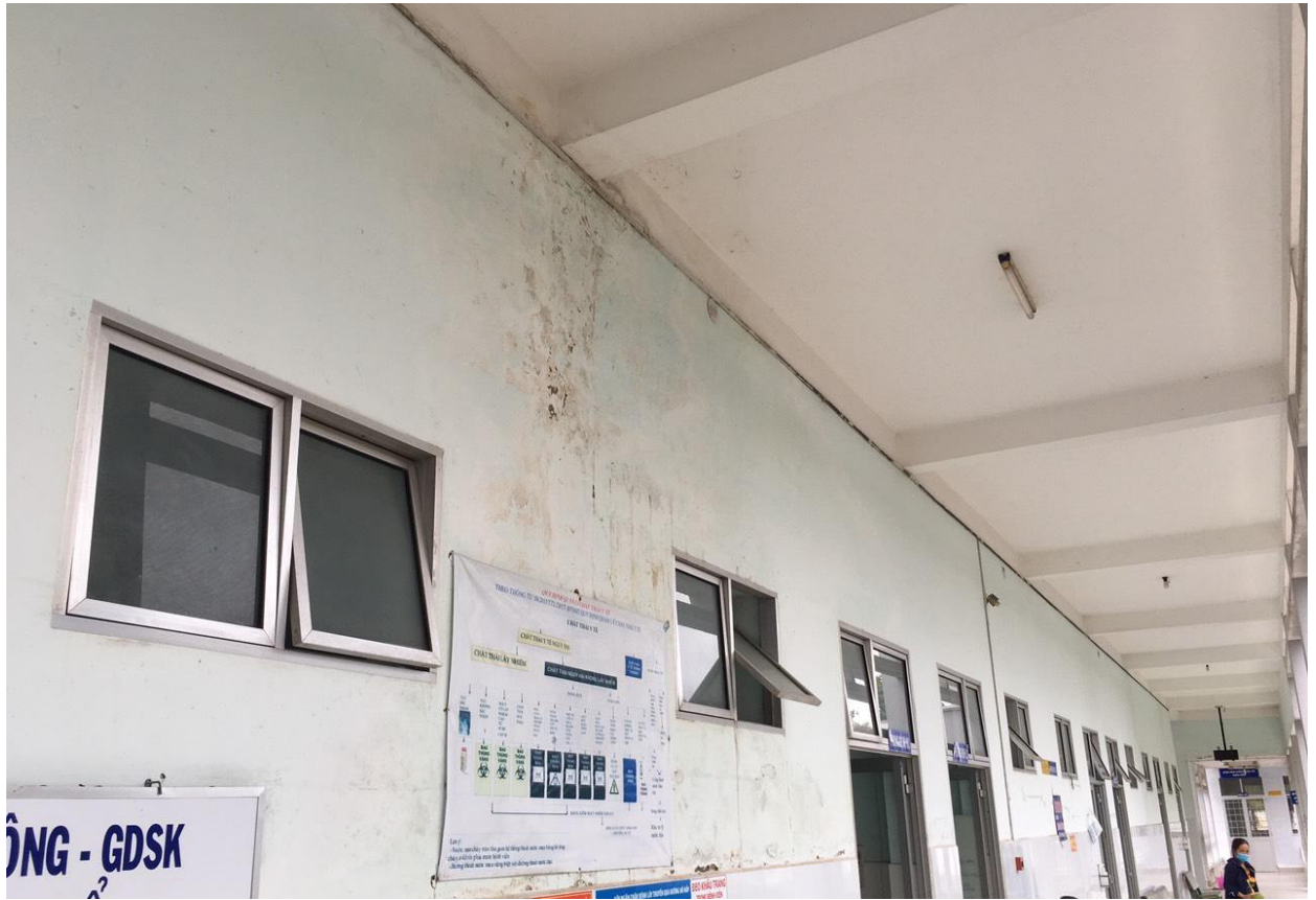
Tường bị thấm, ẩm mốc
