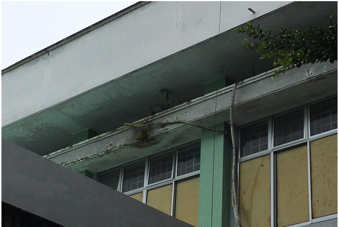
Sàn sênô mái bị thấm
