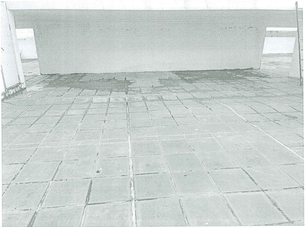
Ảnh hiện trạng sàn mái
