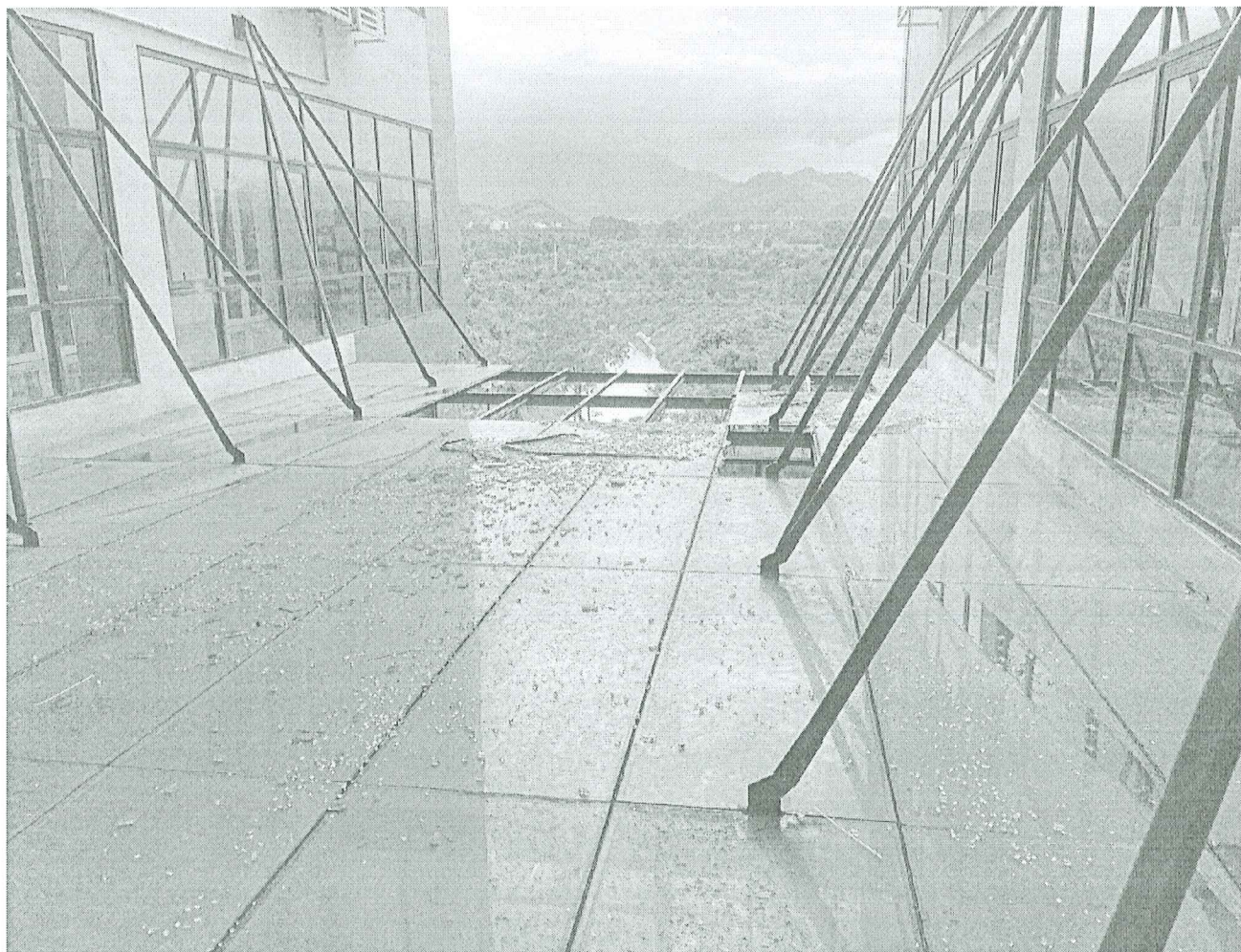
Ảnh hiện trạng mái kính sảnh phụ
