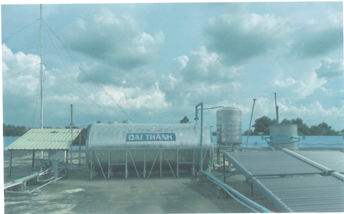
Hình 2-5: Bồn nước và hệ thống làm nóng nước bằng năng lượng mặt trời trên mái TTTM Satra Củ Chi
