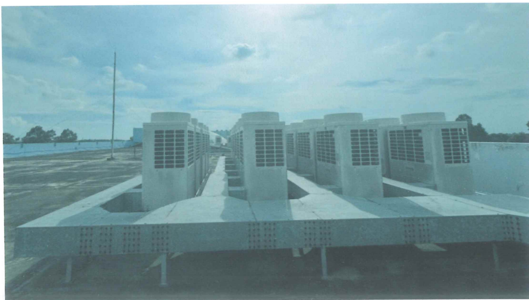
Hình 2-3: Dàn nóng của hệ thống điều hòa không khí trên mái TTTM Satra Củ Chi
