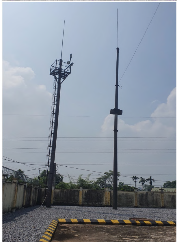
Hình 7. Hệ thống chống sét
