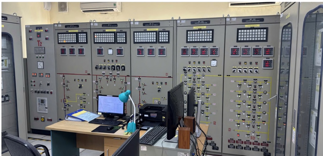
Hình 3. Mặt tủ điều khiển phía 110-35kV
