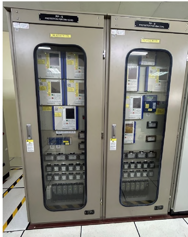
Các tủ bảo vệ phía 35kV
