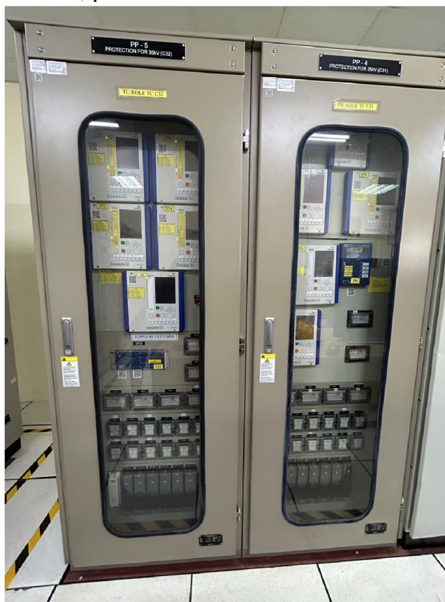
Hình 2. Mặt tủ bảo vệ phía 35kV
