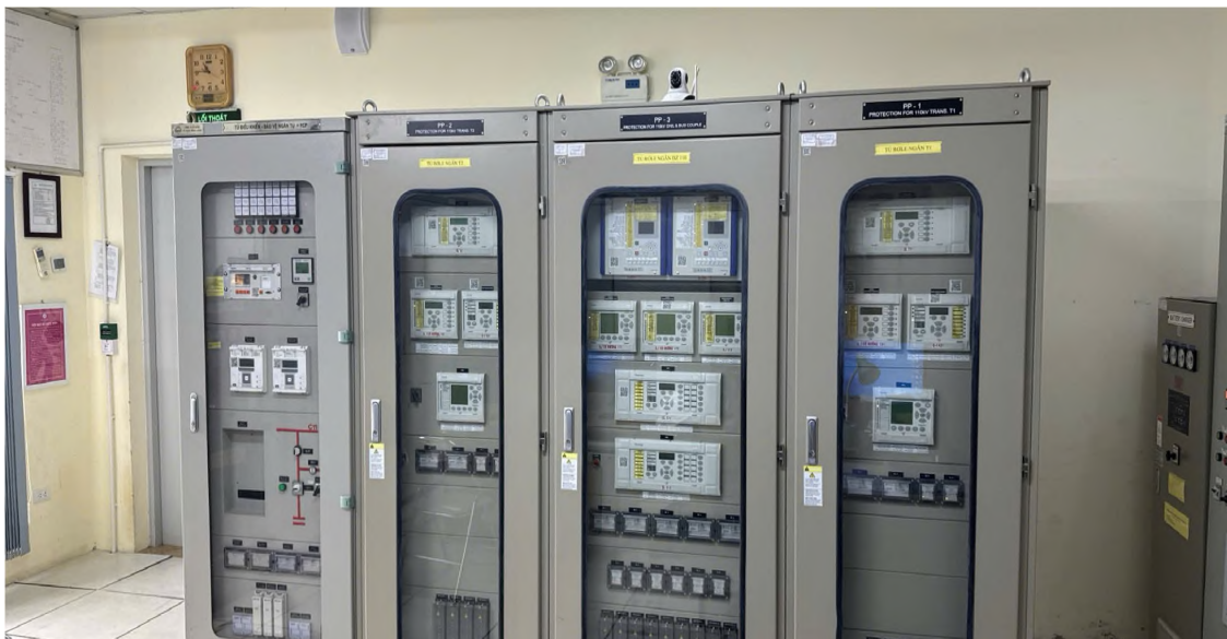
Hình 1. Mặt tủ bảo vệ phía 110kV
