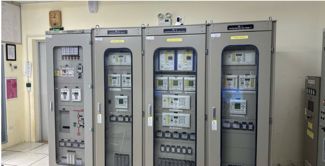
Dãy tủ bảo vệ phía 110kV
