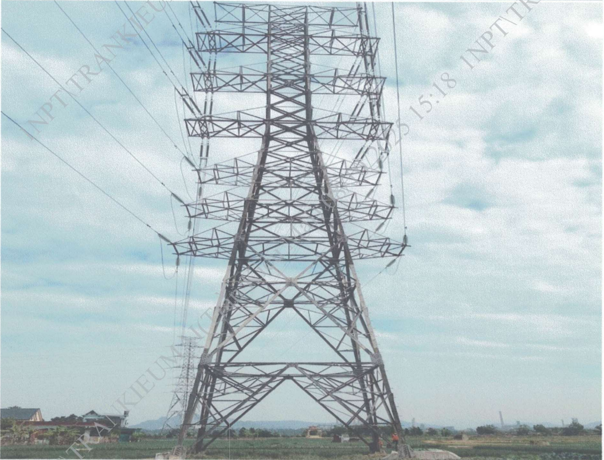
Ảnh hiện trạng VT45 phần sơn cột cảnh báo tín hiệu đường hàng không đang bị bong tróc, mờ. ĐZ 273 Mạo Khê (A5.25) – 274 Hải Dương 2 (E8.20) & ĐZ 274 Mạo Khê (A5.25) – 273 Hải Dương 2 (E8.20)
