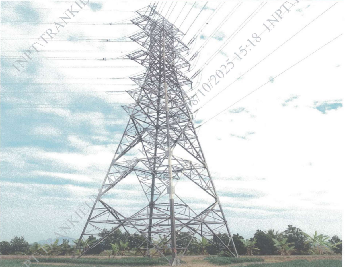
Ảnh hiện trạng VT44 phần sơn cột cảnh báo tín hiệu đường hàng không đang bị bong tróc, mờ. ĐZ 273 Mạo Khê (A5.25) – 274 Hải Dương 2 (E8.20) & ĐZ 274 Mạo Khê (A5.25) – 273 Hải Dương 2 (E8.20)
