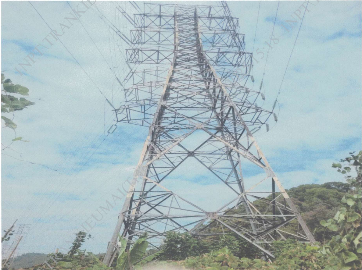
Ảnh hiện trạng VT50 phần sơn cột cảnh báo tín hiệu đường hàng không đang bị bong tróc, mờ. ĐZ 273 Mạo Khê (A5.25) – 274 Hải Dương 2 (E8.20) & ĐZ 274 Mạo Khê (A5.25) – 273 Hải Dương 2 (E8.20)
