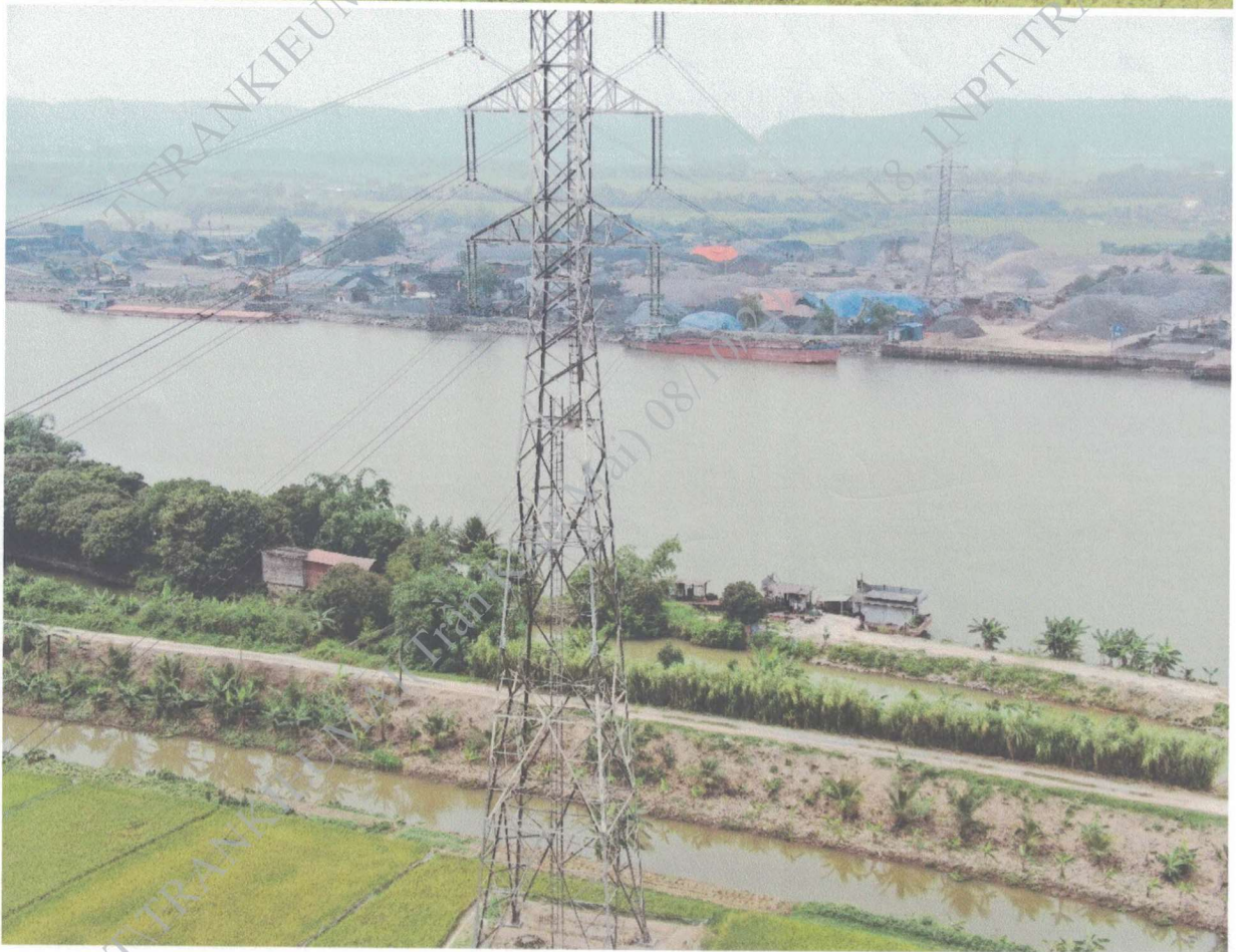
Ảnh hiện trạng VT34 phần sơn cột cảnh báo tín hiệu đường hàng không đang bị bong tróc, mờ. ĐZ 273 Mạo Khê (A5.25) – 274 Hải Dương 2 (E8.20) & ĐZ 274 Mạo Khê (A5.25) – 273 Hải Dương 2 (E8.20)
