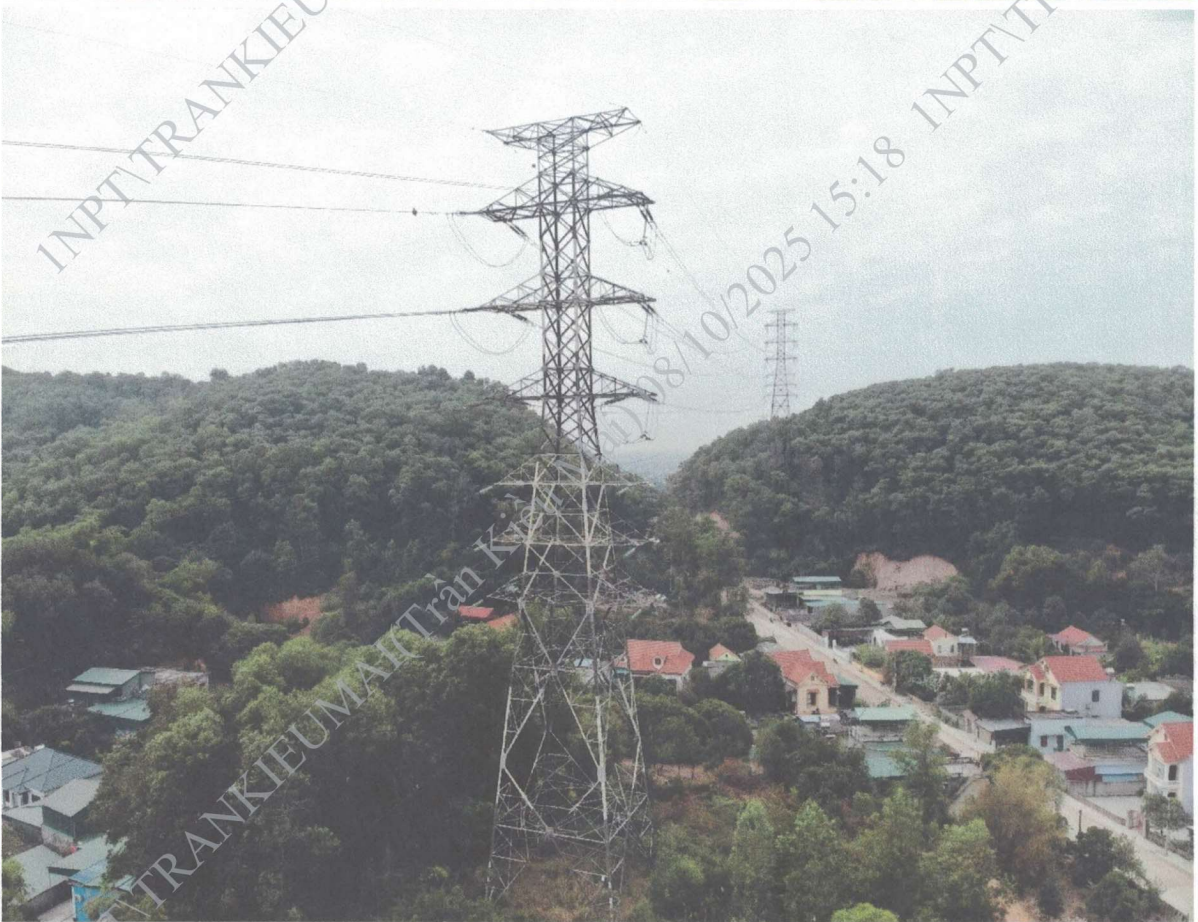
Ảnh hiện trạng VT46 phần sơn cột cảnh báo tín hiệu đường hàng không đang bị bong tróc, mờ. ĐZ 273 Mạo Khê (A5.25) – 274 Hải Dương 2 (E8.20) & ĐZ 274 Mạo Khê (A5.25) – 273 Hải Dương 2 (E8.20)
