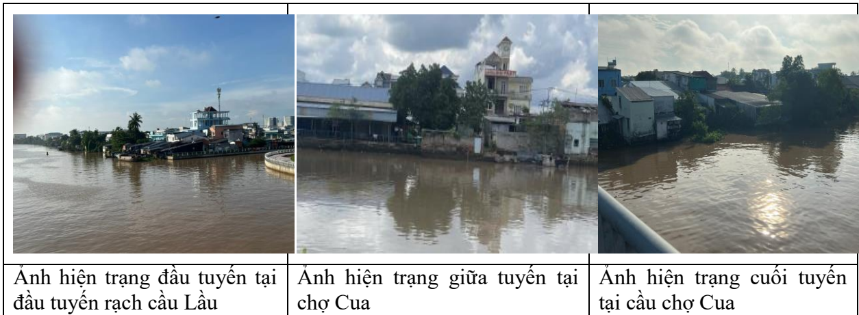
Hình 3 – Hiện trạng khu vực tuyến kè
