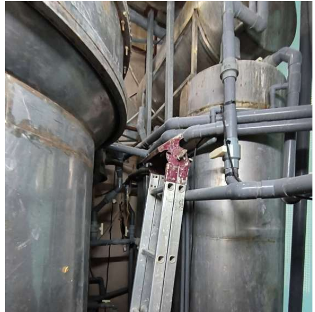
Thiết bị xử lý hiện trạng
