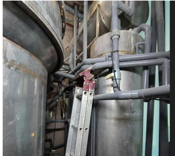
Thiết bị xử lý hiện trạng
