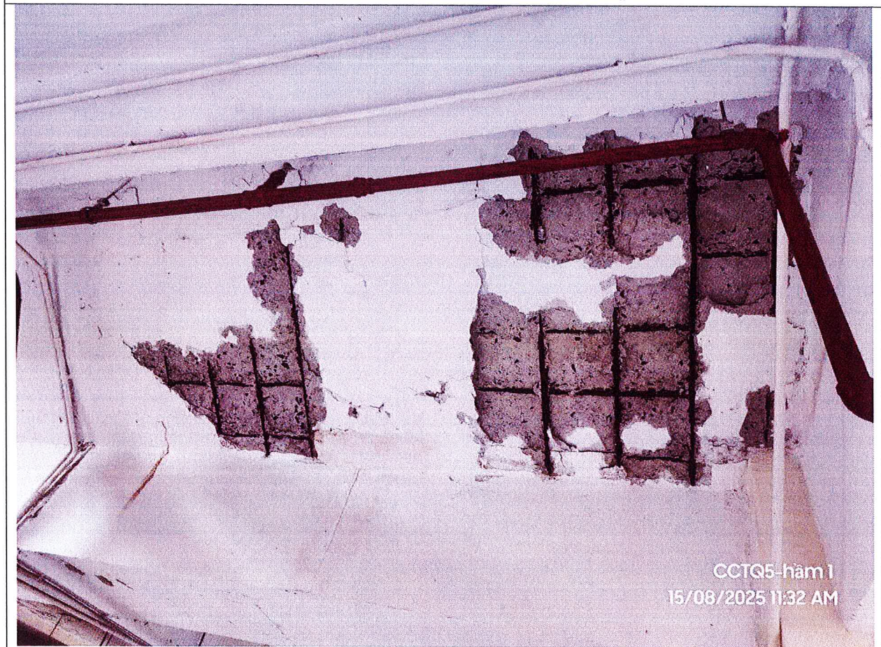
Sàn bị bong tróc bê tông, rỉ sét cốt thép
