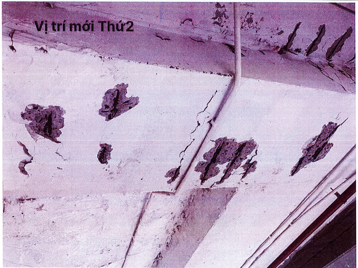
Dầm bị bong tróc bê tông, rỉ sét cốt thép
