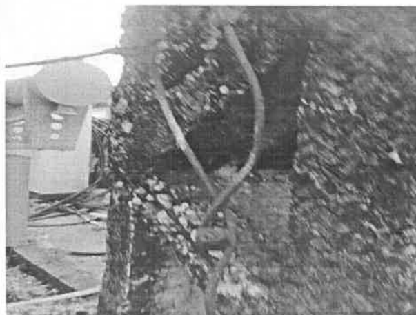
Tiếp địa TBA Yên Thái 1
