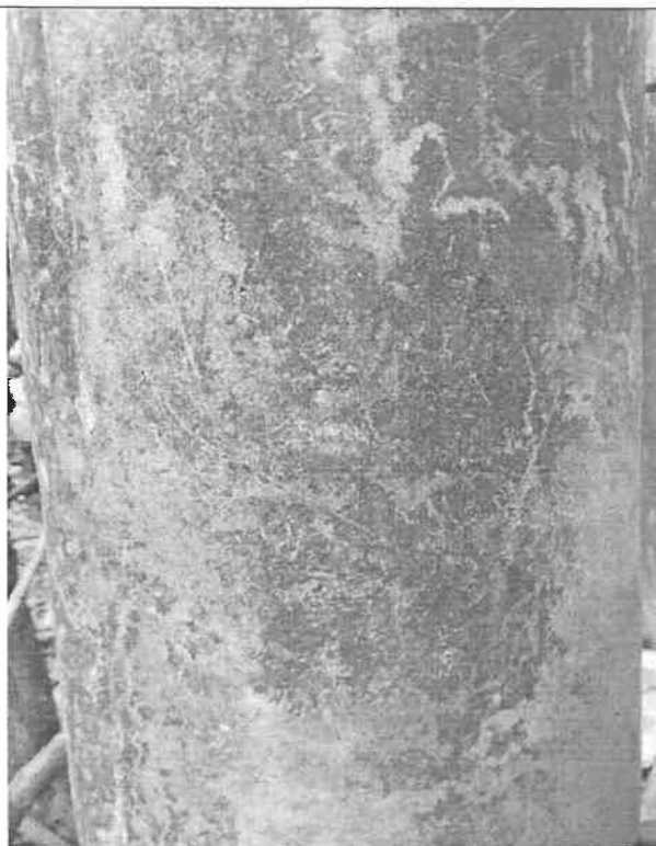
Cột TBA Yên Thái 2
