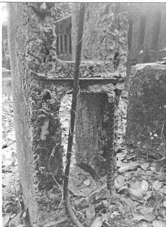
Cột, Tiếp địa TBA Yên Trường 2
