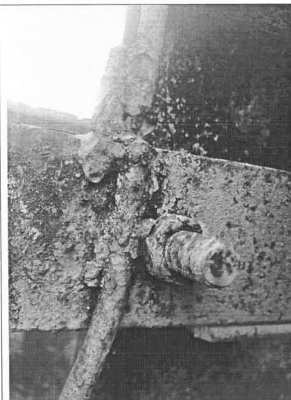
Tiếp địa TBA Yên Phong 2
