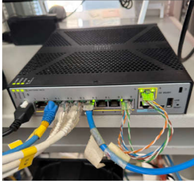
FIREWALL SẼ THU HỒI TBA 110KV AN KHÊ
