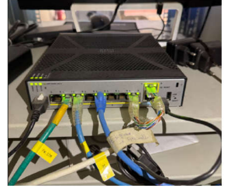
FIREWALL SẼ THU HỒI TBA 110KV CHỦ SÈ
