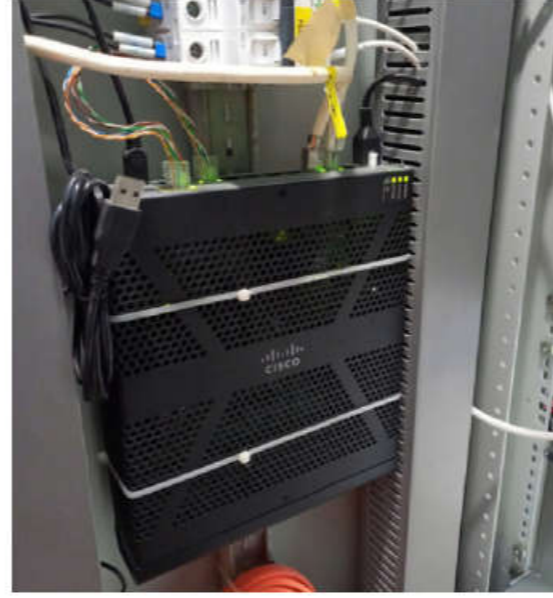
FIREWALL SẼ THU HỒI TBA 110KV K'BANG
