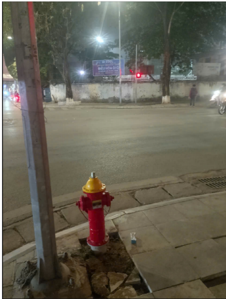
HÌNH ẢNH TRỤ CHỮA CHÁY THÀNH PHỐ VÀO CÔNG TRÌNH
