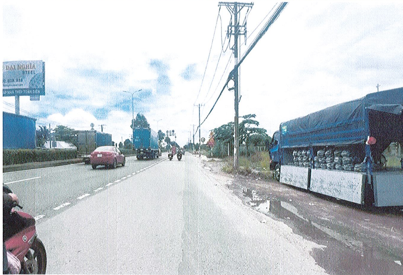
Hình 6: Đường vào cầu An Hạ 2 Mặt đường xuống cấp, đọng nước
