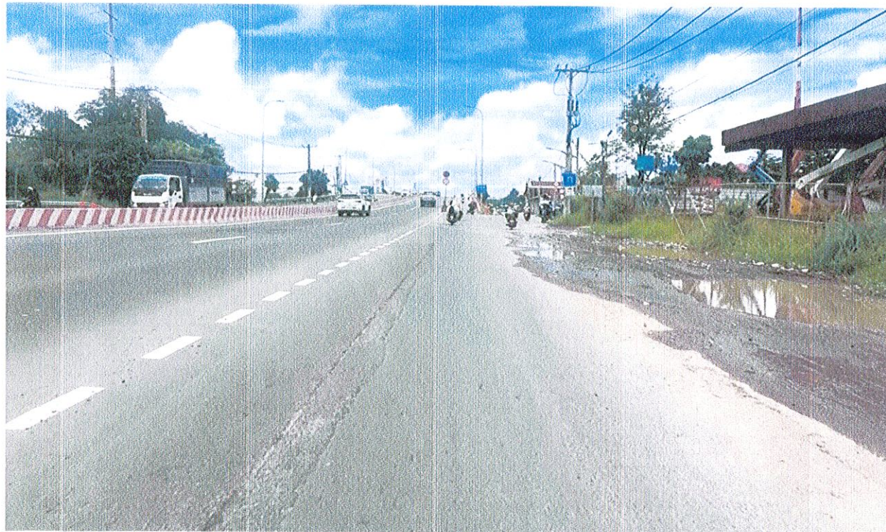
Hình 1: Đường vào cầu An Hạ 1 Mặt đường bị bong tróc, rạn nứt xuống cấp, đọng nước
