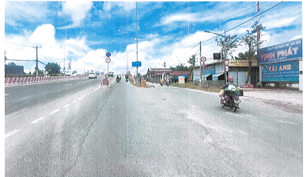
Hình 2: Đường vào cầu An Hạ 1 Mặt đường bị bong tróc, rạn nứt xuống cấp
