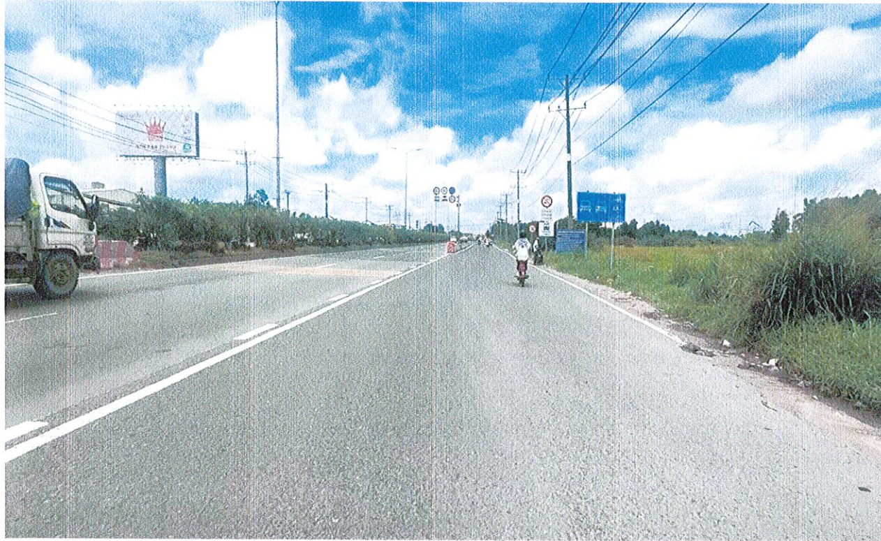
Hình 4: Đường vào cầu An Hạ 1 Mặt đường xuống cấp, dễ đọng nước
