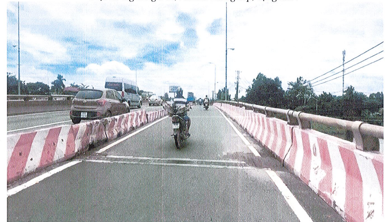
Hình 6: Đường vào cầu An Hạ 2 Mặt cầu xuống cấp
