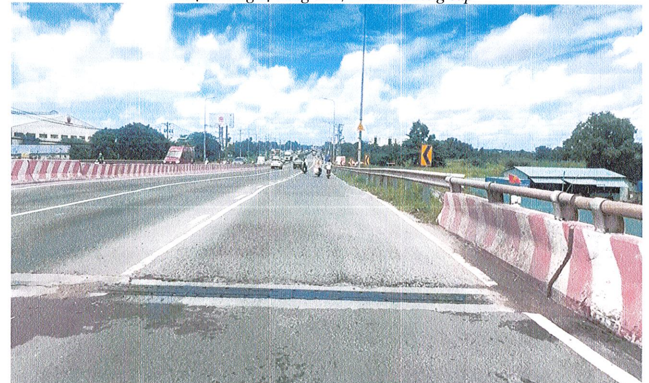
Hình 3: Đường vào cầu An Hạ 1 Mặt đường bị bong tróc, rạn nứt xuống cấp
