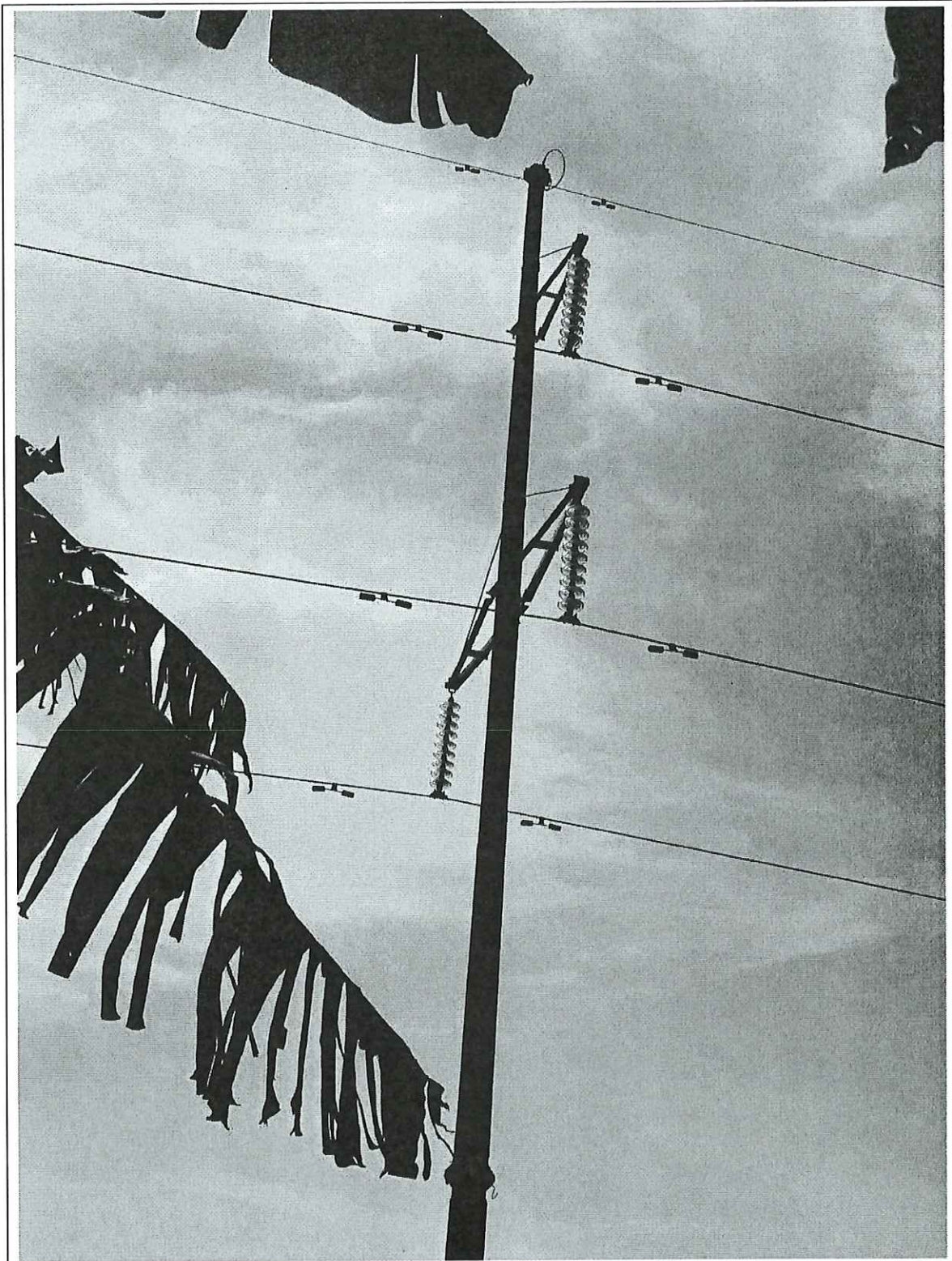
Ảnh VT115 ĐZ110kV Nước Lương – Hoài Nhơn
