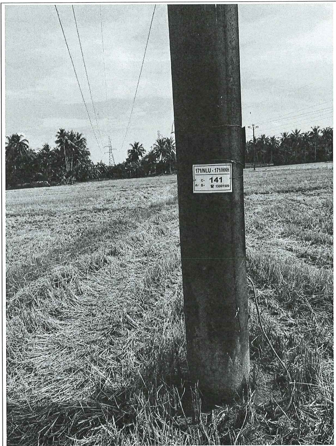
Ảnh VT141 ĐZ110kV Nước Lương – Hoài Nhơn
