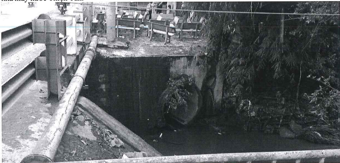
Hình 2.2.8 – Cống xả bên cầu qua suối đường Hoàng Văn Bồng, cống D600mm và D1800mm, hướng đi ra QL1A.
