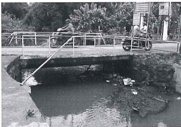
Hình 2.2.5 – Cầu qua suối hẻm 134, đường Nguyễn Ái Quốc, cửa xả cống thoát nước bị bồi lấp.
