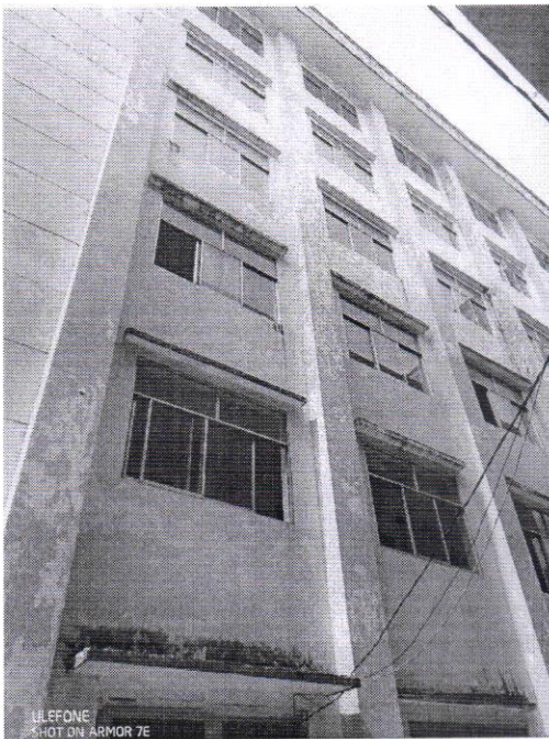
(Hiện trạng khối nhà 6 tầng, hệ cửa nhôm kính hư hỏng)
