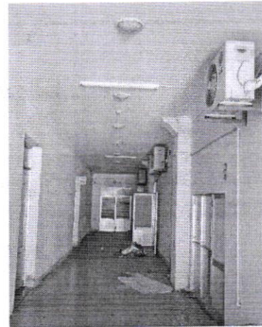
(Đèn chiếu sáng hành lang, Điều hòa tại Khán đài A)
