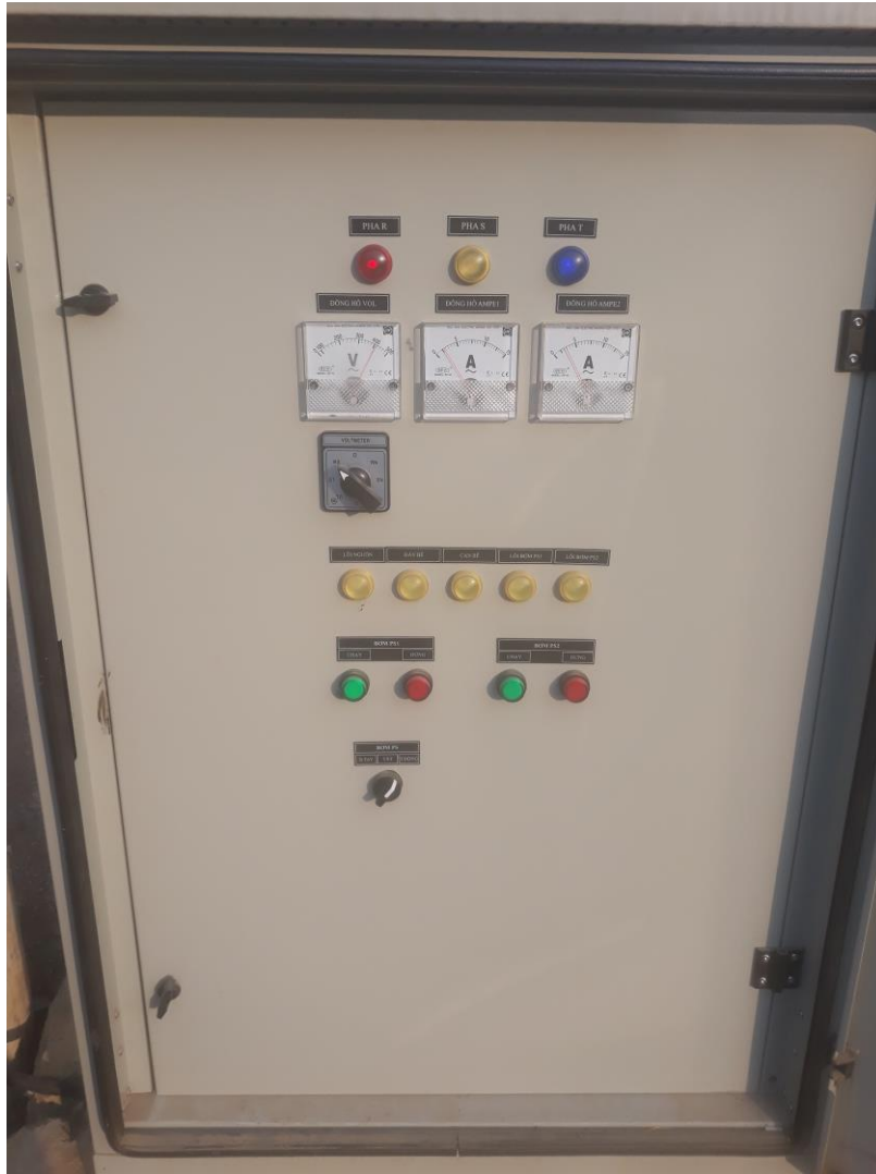
Hình 3: Tủ điều khiển trạm bơm PSI chạy bằng chế độ AUTO
