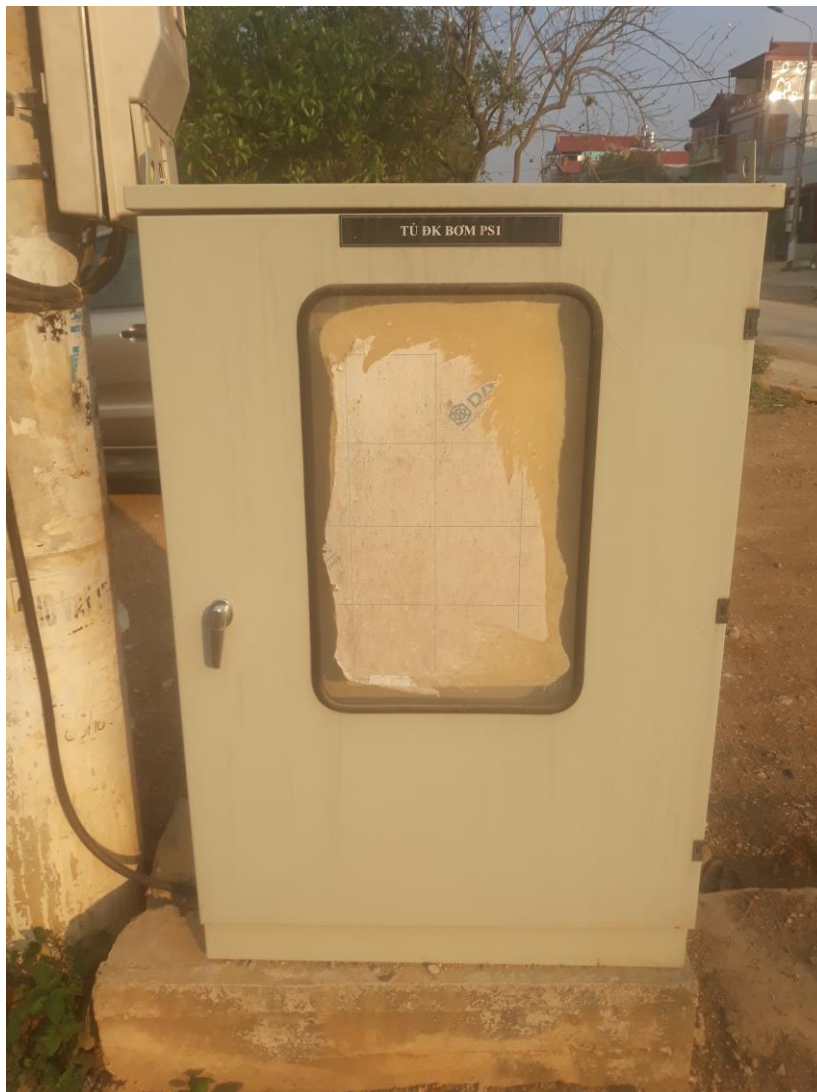
Hình 1: Tủ điều khiển trạm bơm PS1
