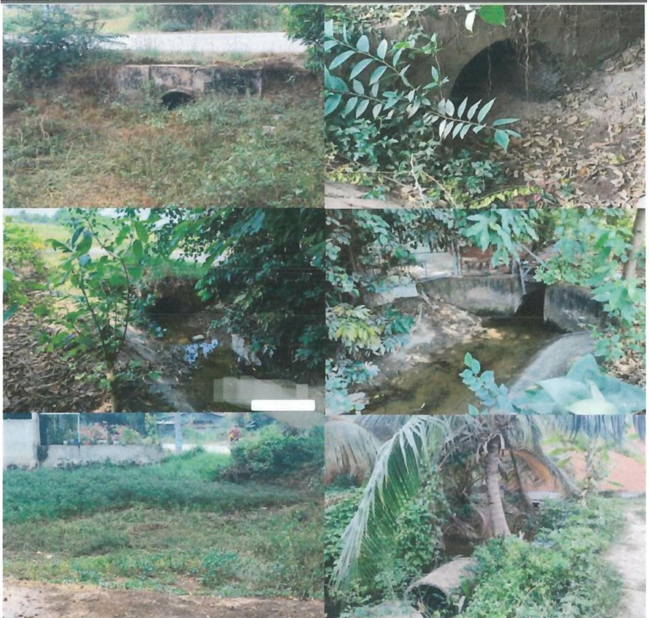
Hiện trạng một số công ngang trên tuyến
