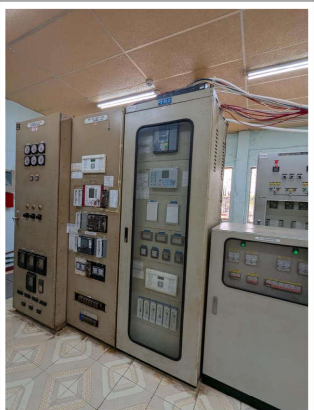
Hệ thống tủ bảo vệ hiện hữu
