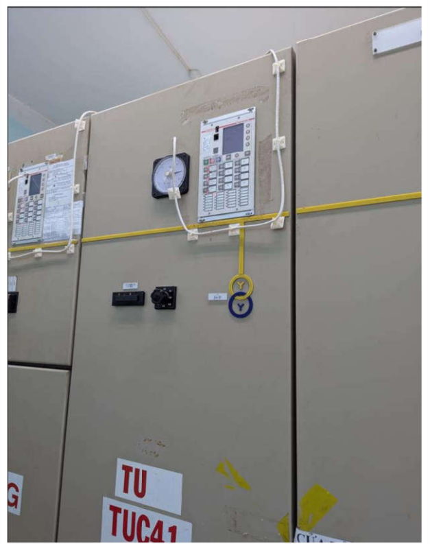
Giàn tủ hợp bộ 22kV giàn C41 hiện hữu
