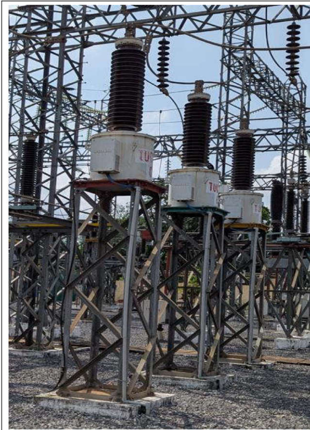
- Máy biến điện áp TUC11 hiện hữu
