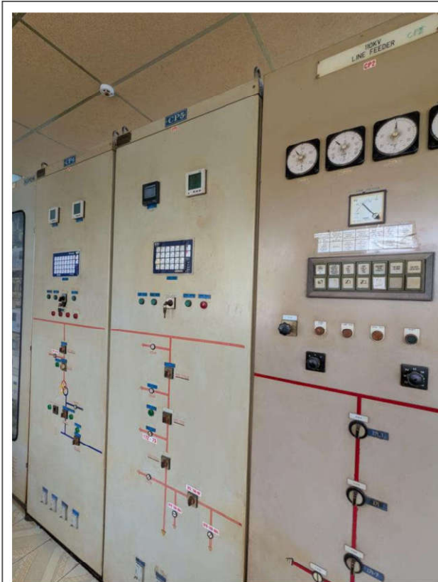
Hệ thống tủ điều khiển hiện hữu
