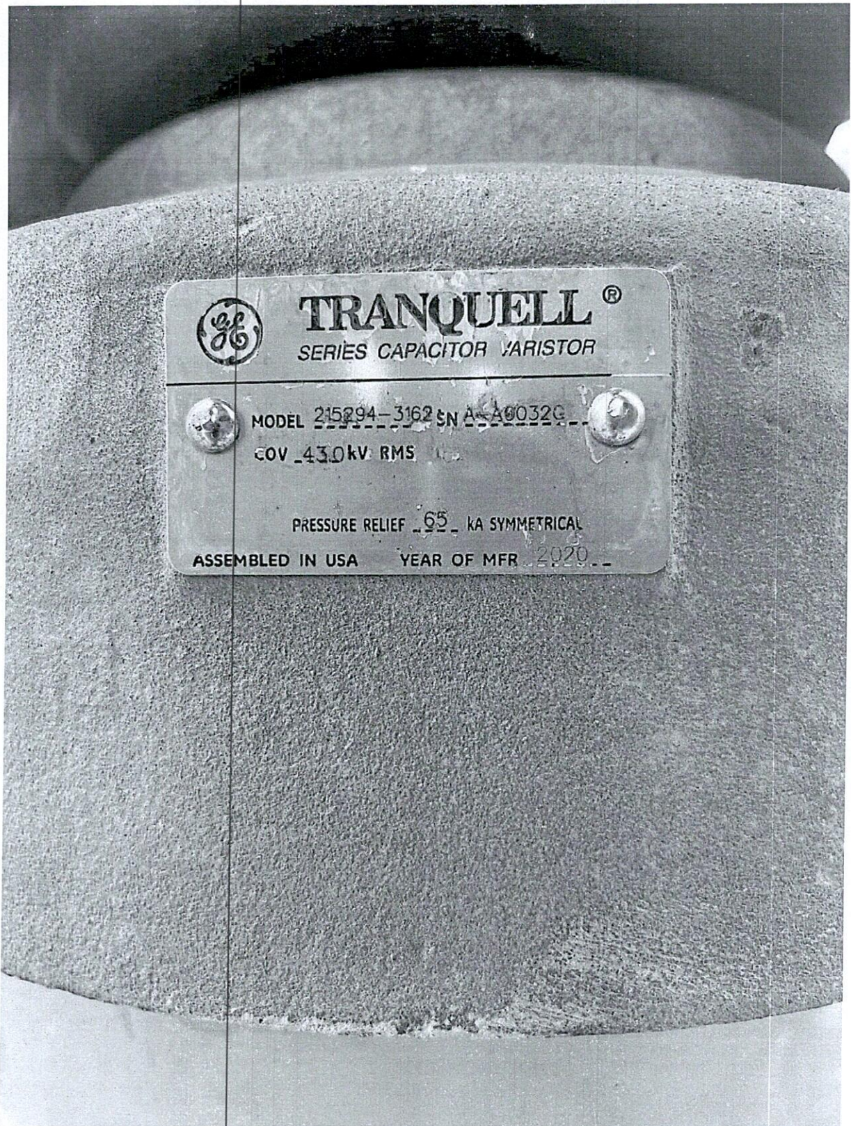
Hình 2: Nhãn MOV pha B TBD503 hiện hữu TBA 500kV Quảng Trạch
