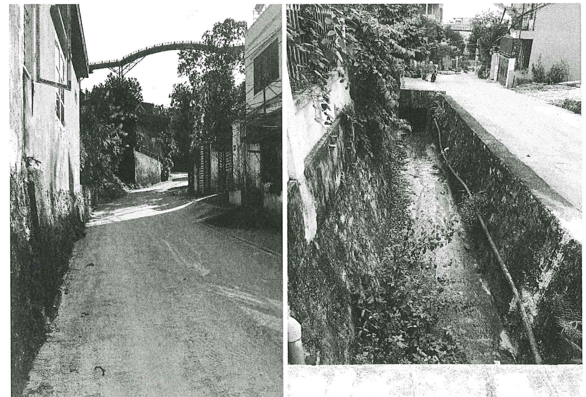
Hiện trạng tuyến đường và hệ thống mương hở thoát nước
