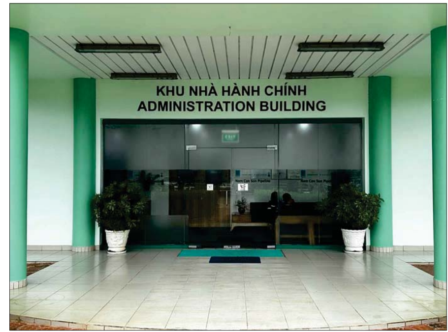
ẢNH HIỆN TRẠNG CỬA KÍNH TÒA NHÀ HÀNH CHÍNH
