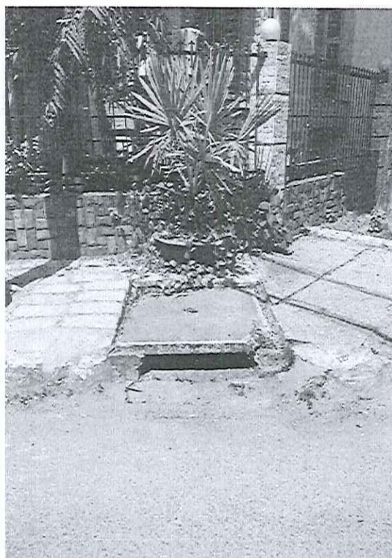
Miệng thu nước hầm ga xuống cấp
