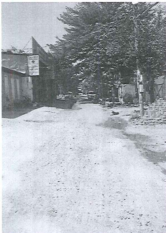
Mặt đường nhựa hiện hữu xuống cấp
