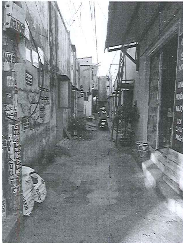
Hạ tầng điện, thông tin hiện hữu
