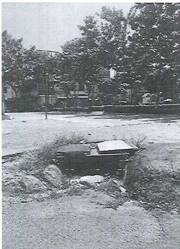
Miệng thu nước hầm ga xuống cấp
