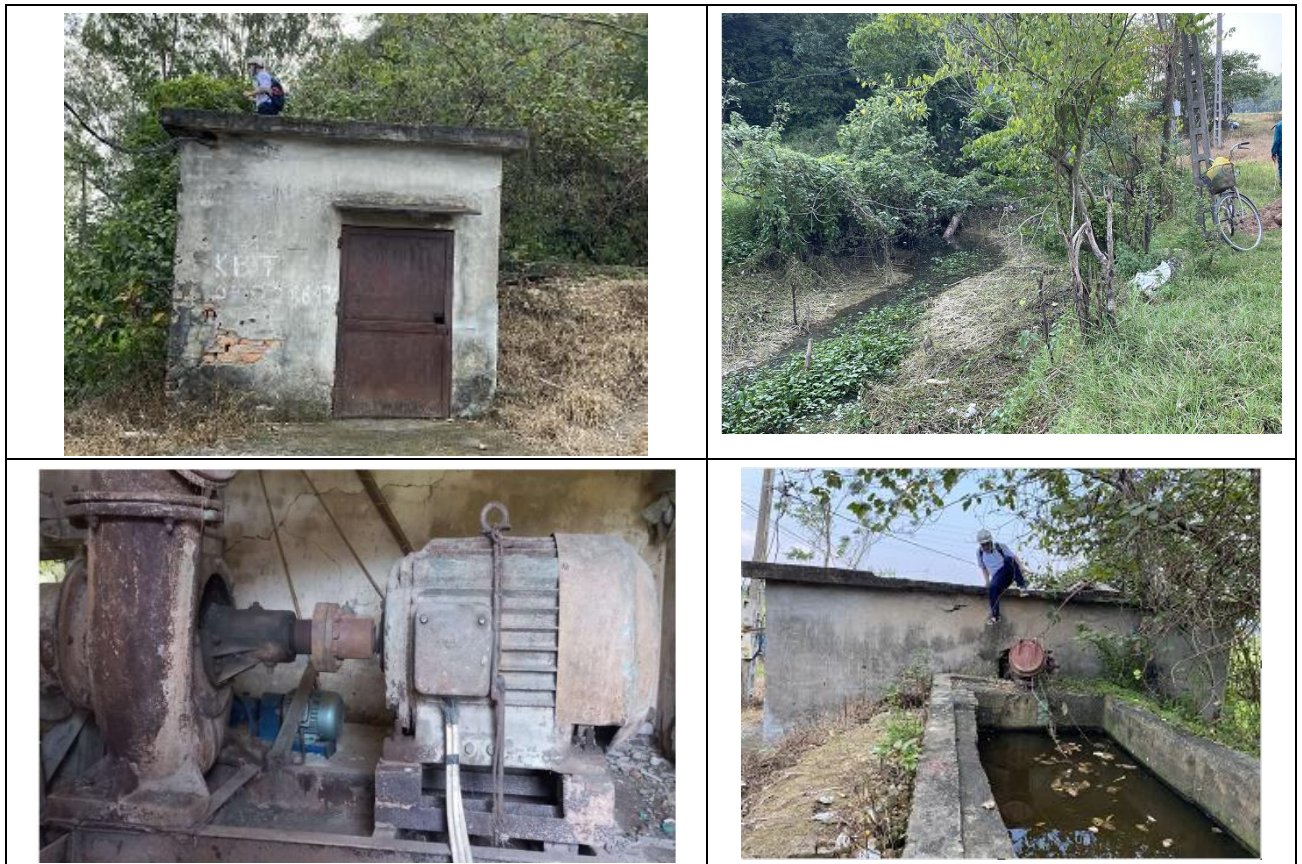
Hình 2.17: ảnh hiện trạng trạm bơm tưới Xó Núi xã Yên Sơn
