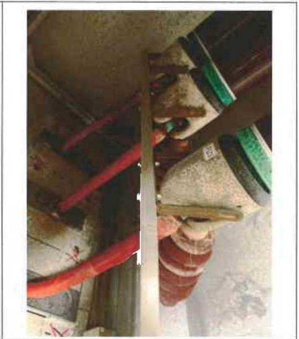
Vị trí bắt cáp điện bị hoen rỉ
