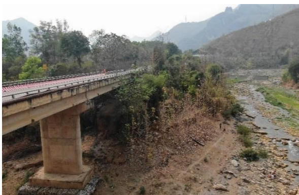
Hình 4. Hình ảnh trụ cầu T1
