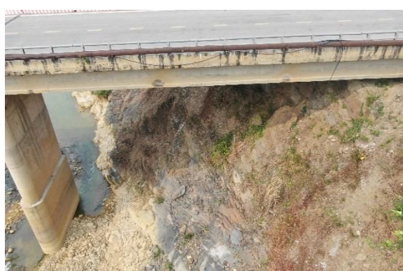
Hình 5. Hình ảnh trụ cầu T2
