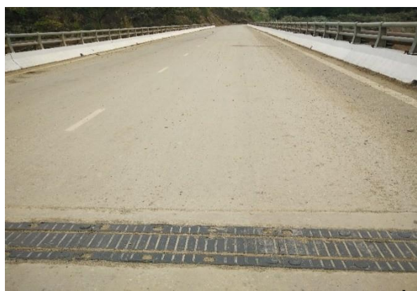
Hình 11. Hình ảnh khe co giãn, mặt cầu
