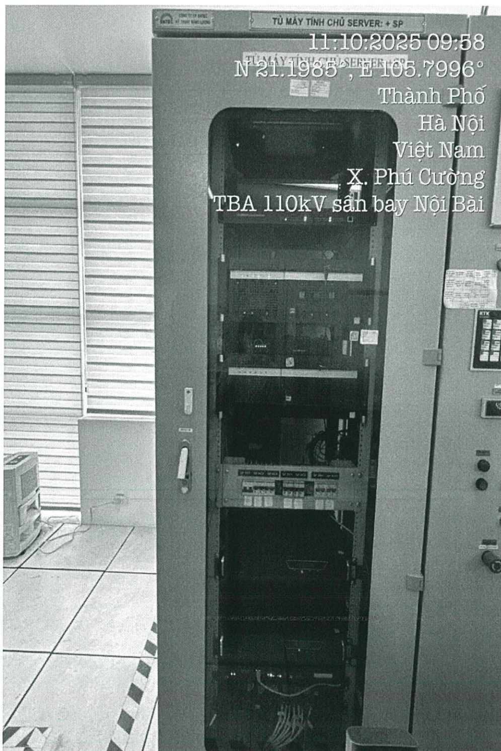
Tủ máy tính server hiện hữu tại trạm
