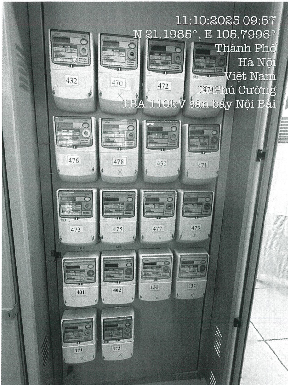
Hình ảnh: Tủ công tơ
