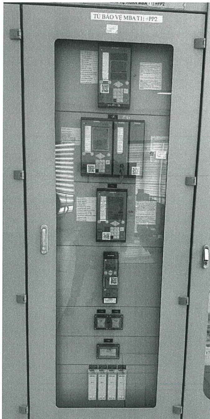
Hình 1. Mặt tủ bảo vệ ngăn máy biến áp T1/T2
