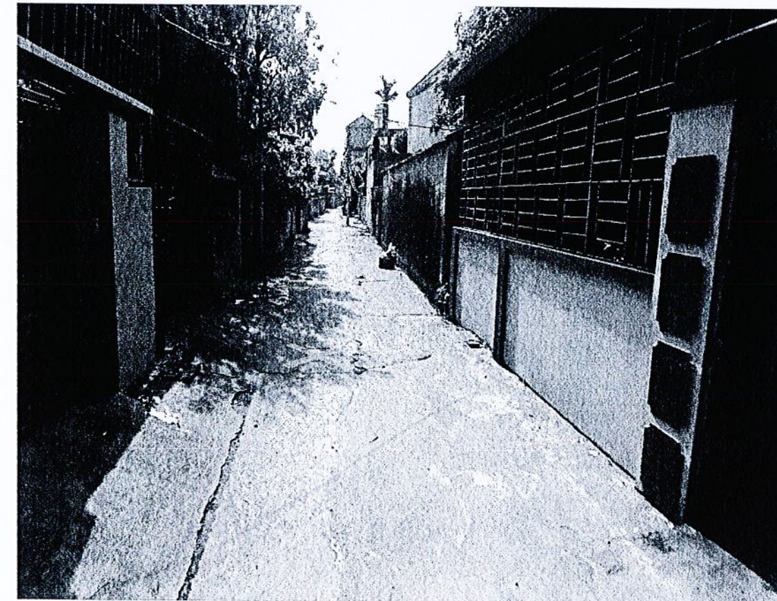
Hình ảnh 3: Chưa có hệ thống thoát nước hiện tượng ngập úng thường xuyên xảy ra, mặt đường bê tông nứt vỡ, hư hỏng.
