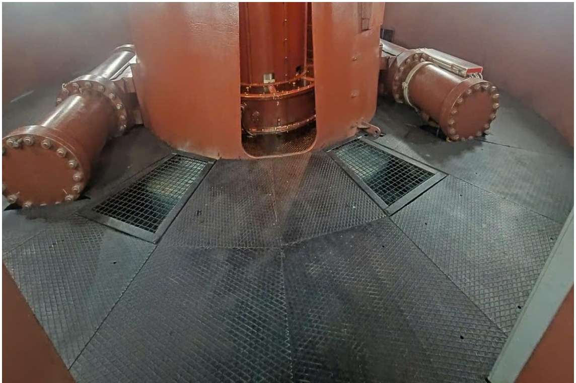
Hình 1: Nắp tua bin và sàn công tác
