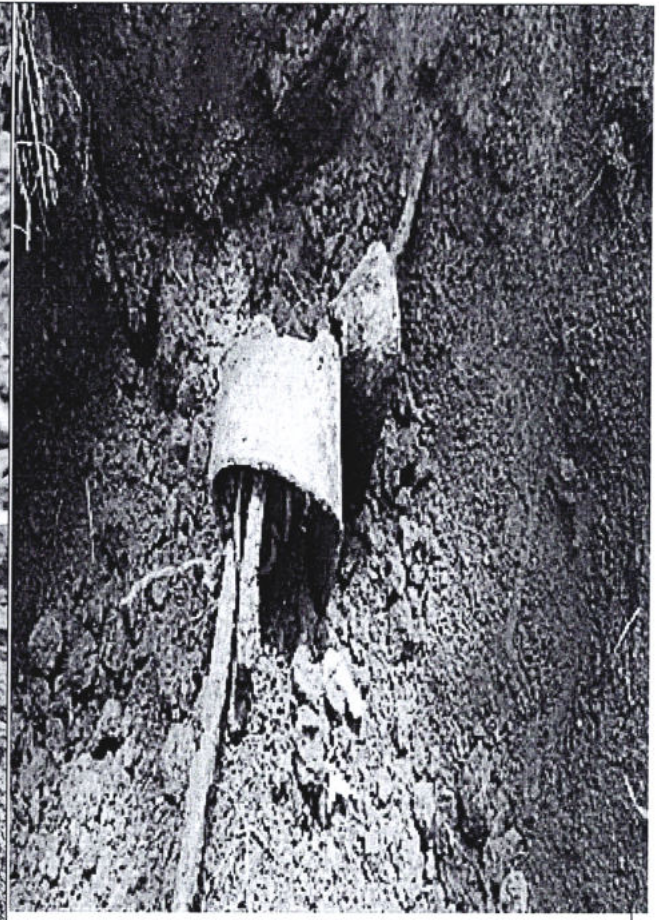
Hình ảnh hệ thống tiếp địa bị bị han gỉ, ăn mòn
