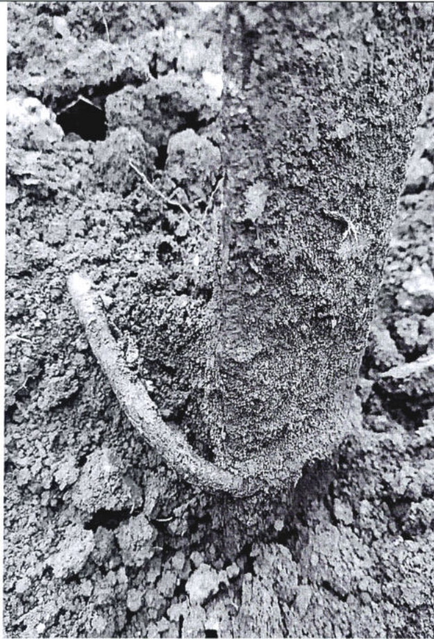
Hình ảnh hệ thống tiếp địa bị bị han gỉ, ăn mòn
