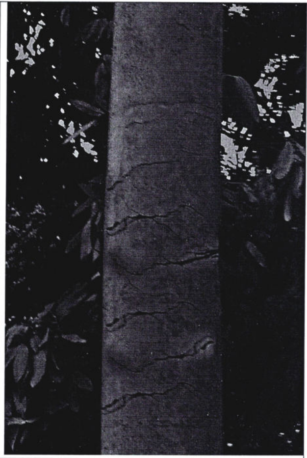
Hình ảnh cột bị rạn nứt , hở lõi thép, cong gù
