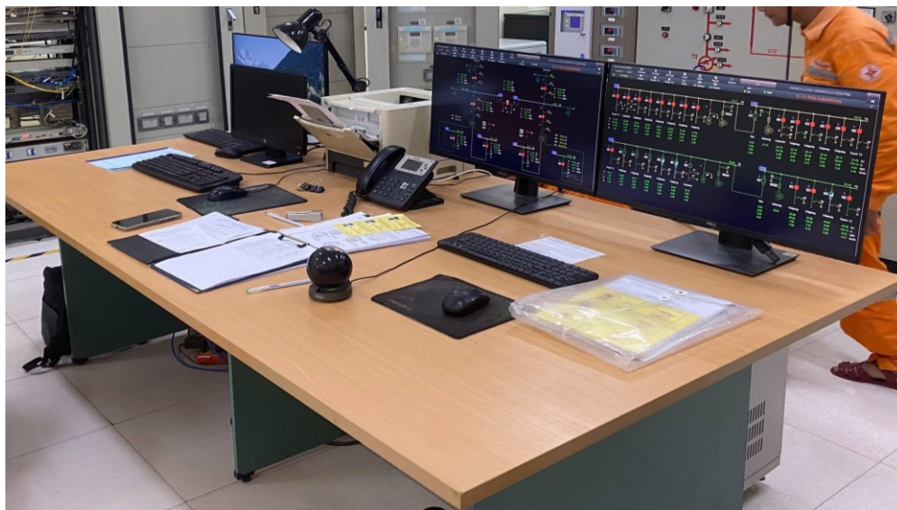
Hình ảnh: Hiện trạng hệ thống máy tính lắp đặt tại trạm
