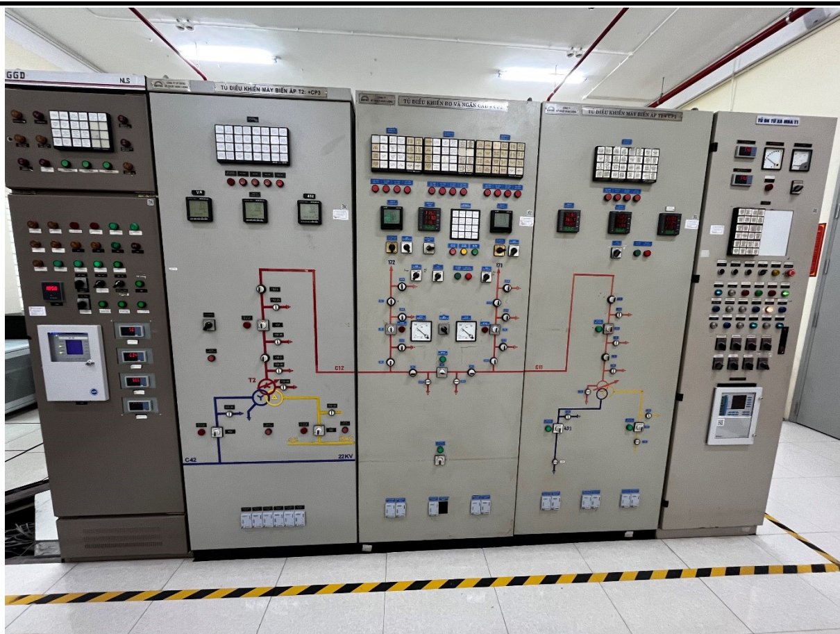
Dãy tủ điều khiển hiện trạng
