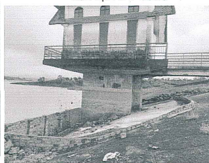
MÁI THƯỢNG LƯU ĐẬP KHU VỰC SỤT LÚN TẠI THÁP CÔNG
