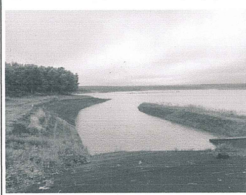
MÁI KÊNH DẪN THƯỢNG LƯU TRẦN BỊ XÓI, SẠT LỎ
