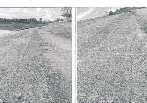
MÁI THƯỢNG LƯU ĐẬP BỊ XÂM THỰC, BONG TRÓC
