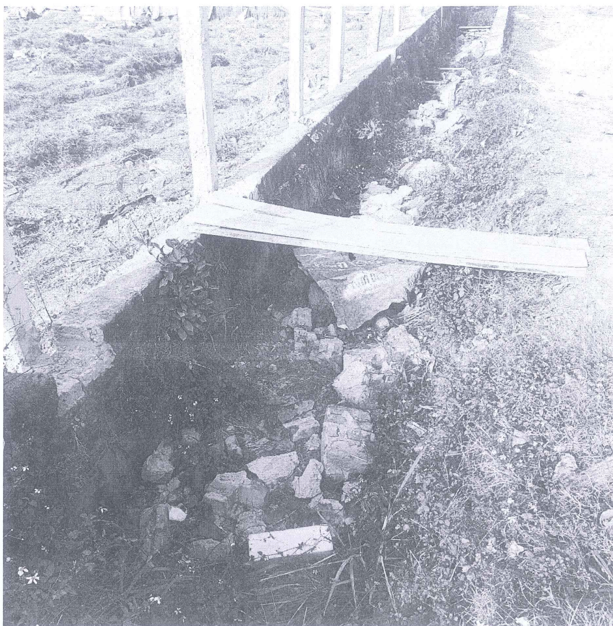
Ảnh 4: Một đoạn cuối tuyến 3 từ đồng Xi Kiếu đến đồng Lò Hóp, hiện trạng mương xây tường đổ sập 01 bên chỉ còn bờ đất.
