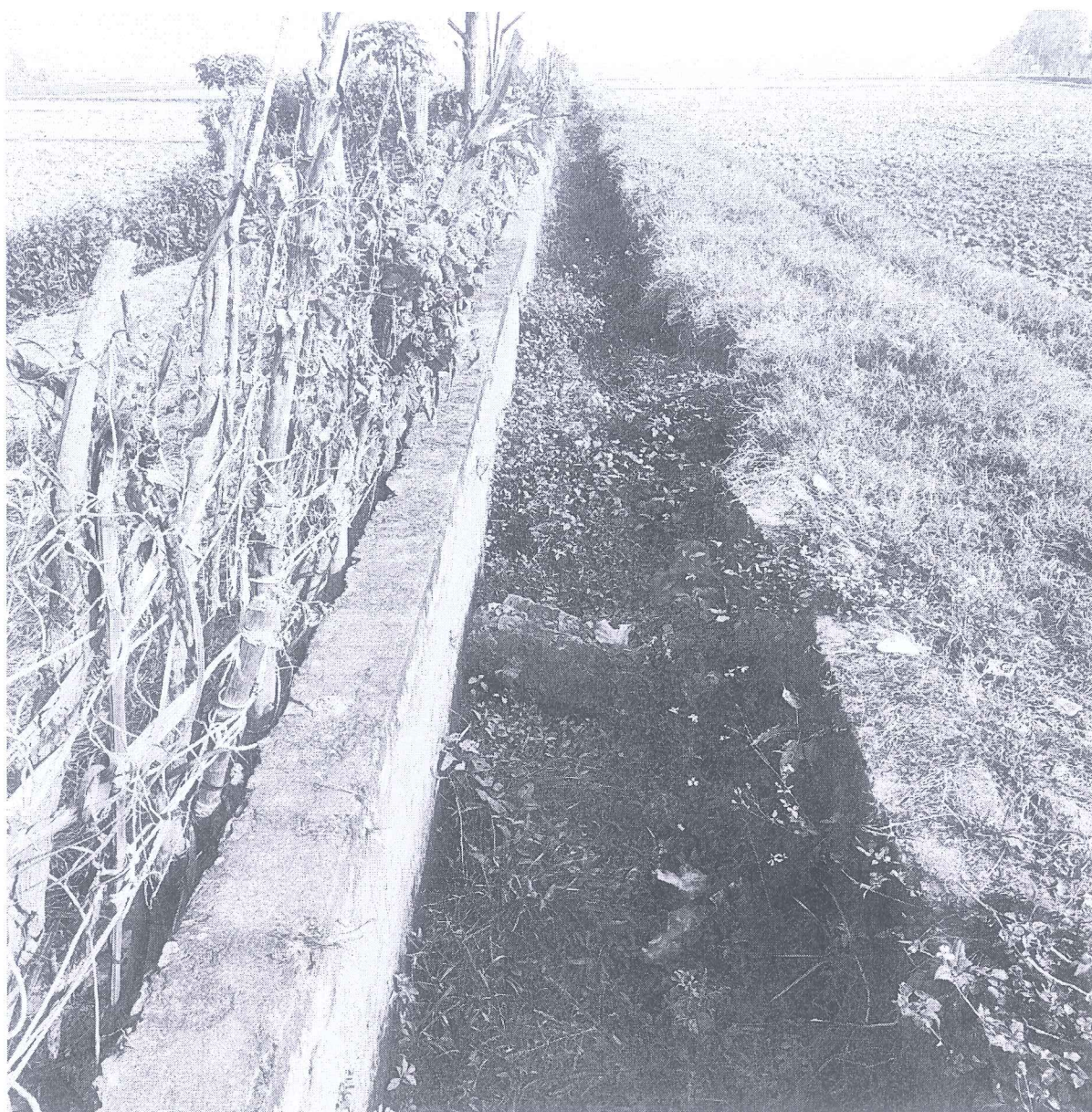
Ảnh 3: Một đoạn đầu tuyến 3 từ đồng Xi Kiều đến đồng Lò Hóp, hiện trạng mương xây tường nứt vỡ, đổ sập 1 bên.
