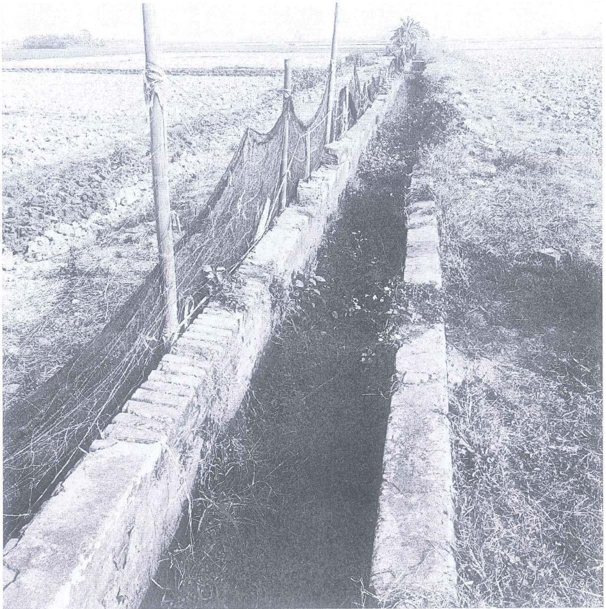
Ảnh 3: Một đoạn giữa tuyến 3 từ đồng Xi Kiếu đến đồng Lò Hóp, hiện trạng mương xây tường nứt vỡ, đố sập 1 bên chỉ còn bờ đất.
