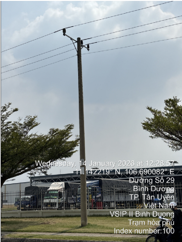
TRỤ 22 NR ĐƯỜNG 28-TUYẾN 471 VĨNH TÂN (hiện hữu)
