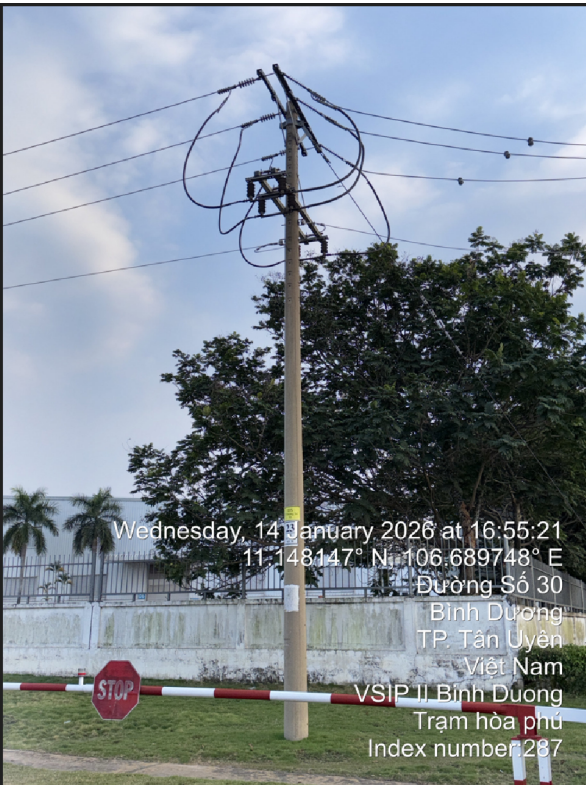
TRỤ 23 NR ĐƯỜNG 30-TUYẾN 471 VĨNH TÂN (hiện hữu)
