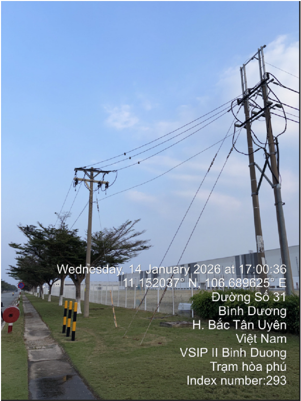
TRỤ 23 NR ĐƯỜNG 31-TUYẾN 471 VĨNH TÂN (hiện hữu)
