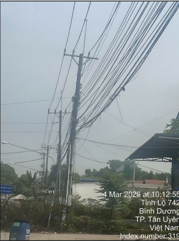
TRỤ 125 NR PHÚ CHÁNH TUYẾN 471 HOÀNG GIA PHÁT (Hiện hữu)
