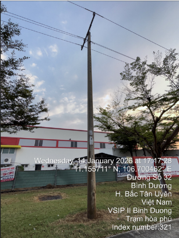
TRỤ 02 NR ĐƯỜNG 32 NỐI DÀI -TUYẾN 474 ĐẠI NGHĨA (SCT)
