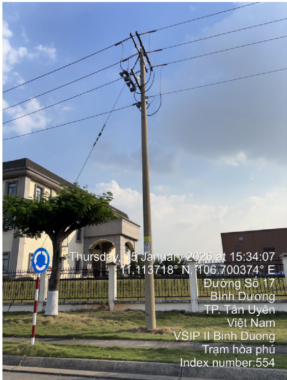
TRỤ 01 NR ĐƯỜNG SỐ 17 HÒA BÌNH -TUYẾN 478 DÂN CHỦ (hiện hữu)
