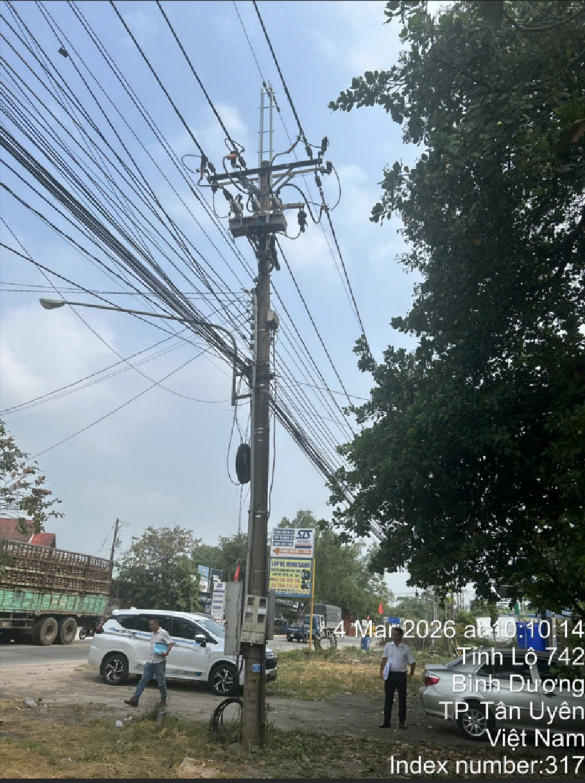
TRỤ 124 NR PHÚ CHÁNH TUYẾN 471 HOÀNG GIA PHÁT (Hiện hữu)
