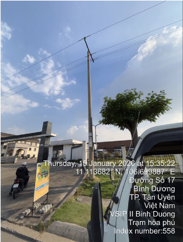
TRỤ 02 NR ĐƯỜNG SỐ 17 HÒA BÌNH -TUYẾN 478 DÂN CHỦ (hiện hữu)
