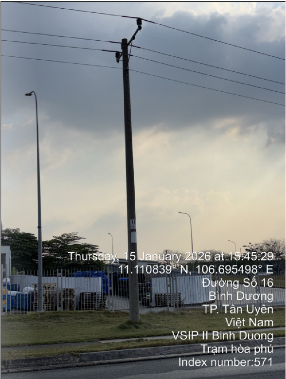
TRỤ 11 NR ĐƯỜNG SỐ 16 - TUYẾN 474 MAI THƯ' (hiện hữu)
