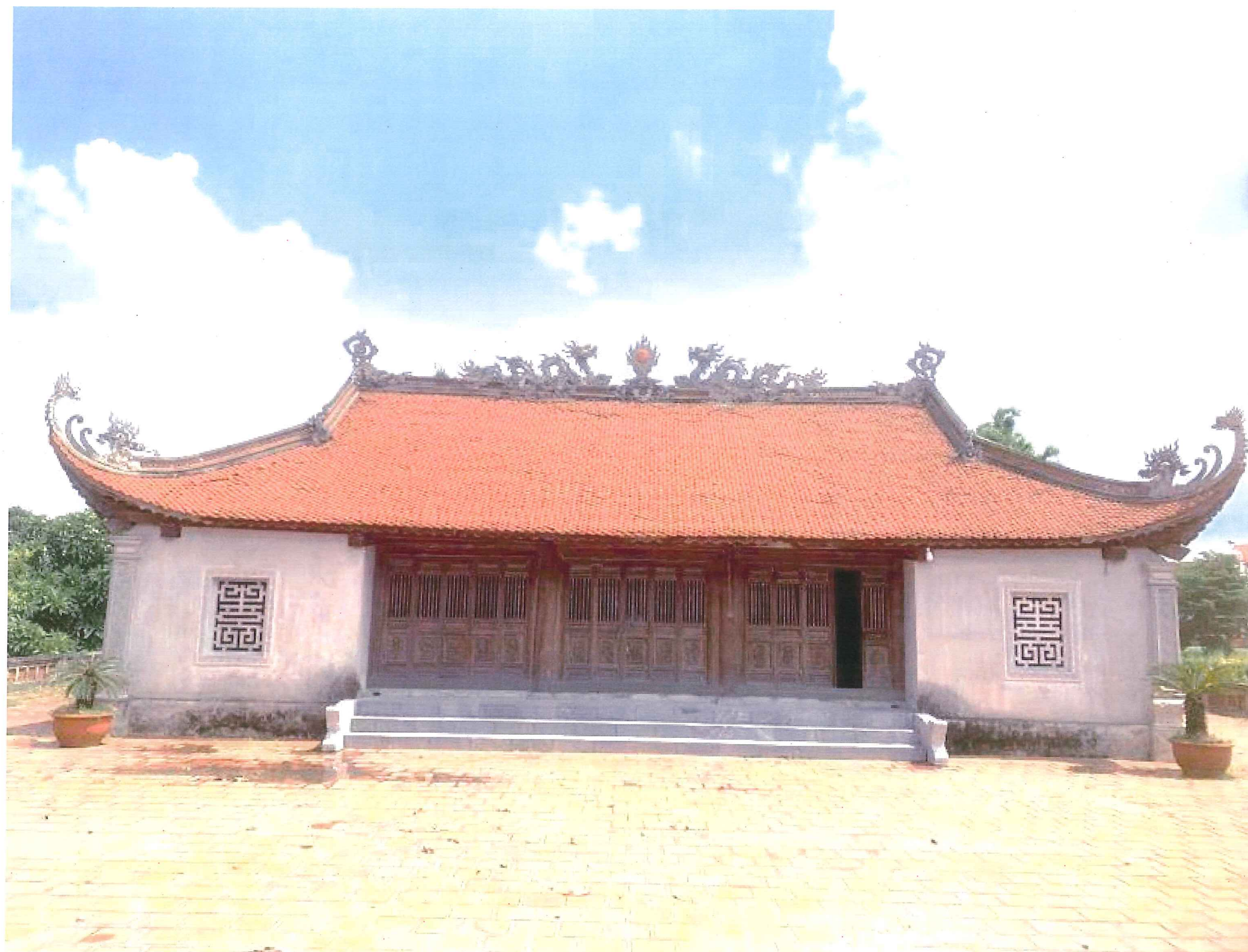
Mặt đứng chính diện Đại Bái (một số vị trí mái ngói bị xô, tụt)
