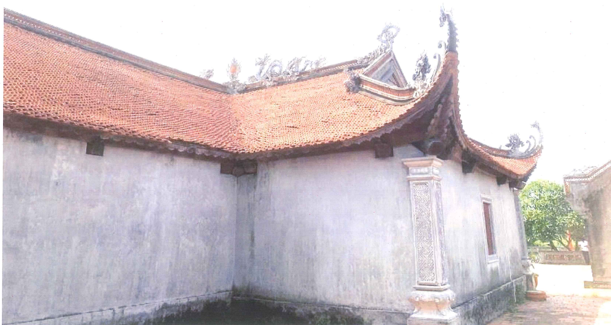
Vị trí Đại bái giao với hậu cung, một số vị trí mái ngói bị xô, tụt, tường nứt mốc
