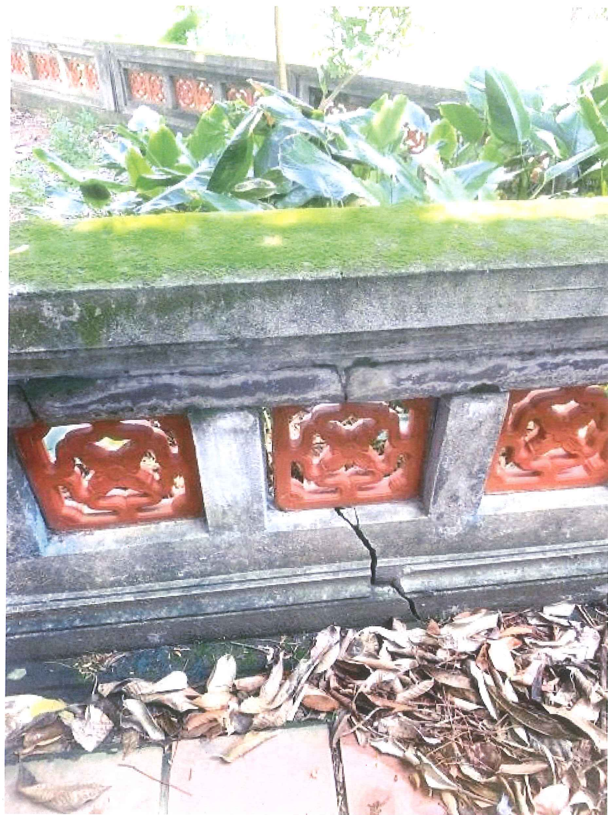
Lan can bị nứt vỡ
