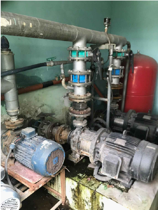
2 MÁY BƠM CẤP NƯỚC ĐI
