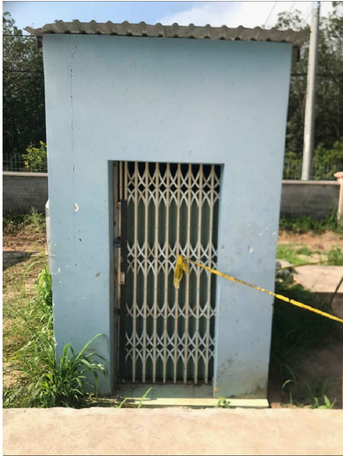
NHÀ CHỨA MÁY BƠM
