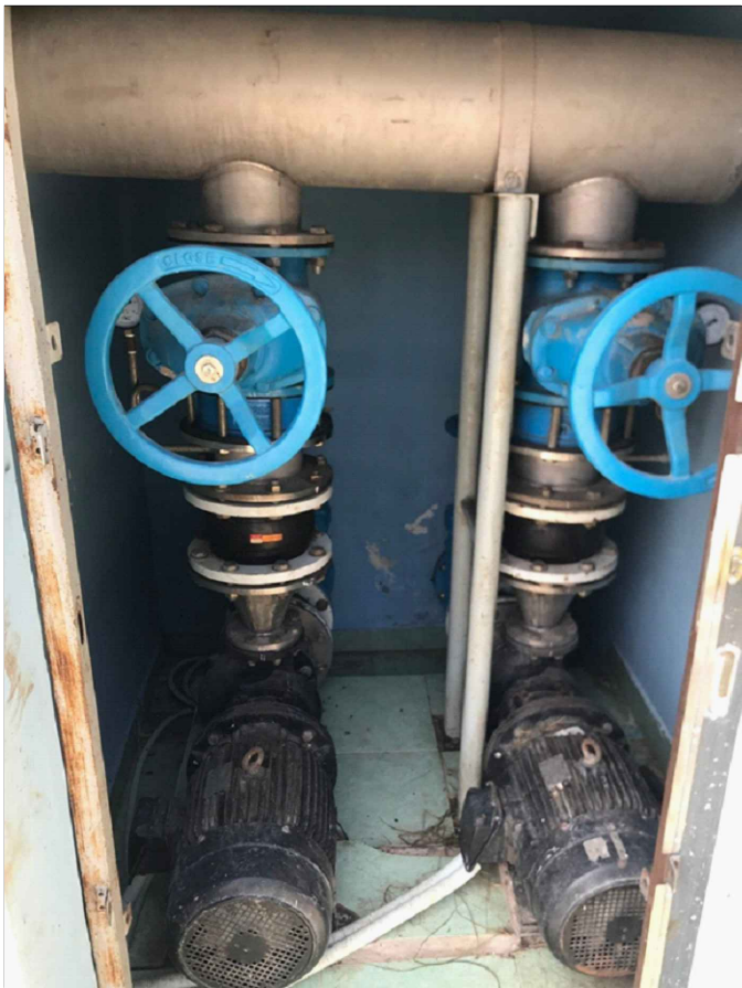
MÁY BƠM NƯỚC LÊN BỂ LỘC
