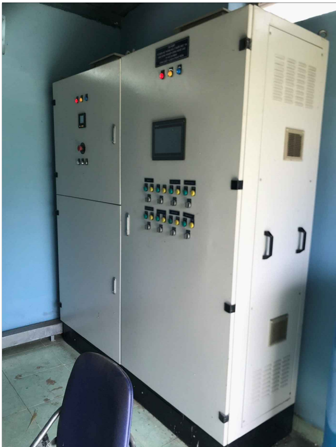
TỦ ĐIỆN ĐIỀU KHIỂN HỆ THỐNG BƠM
