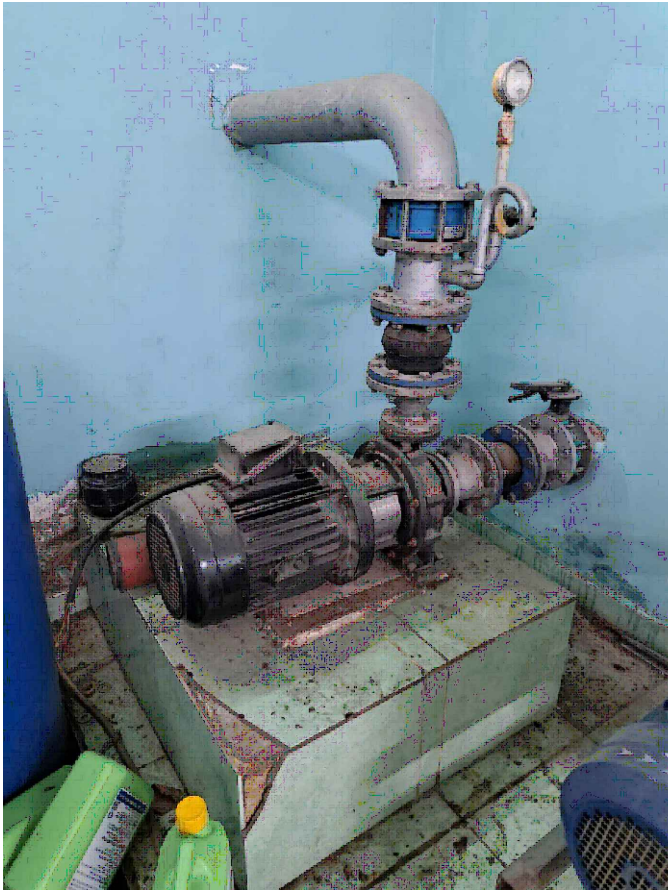
MÁY BƠM TỪ BỂ LỌC XUỐNG HỒ CHỨA
