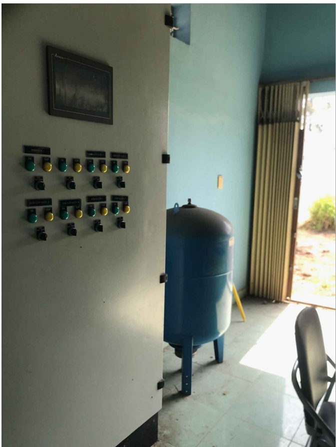
TỦ ĐIỆN ĐIỀU KHIỂN HỆ THỐNG BƠM
