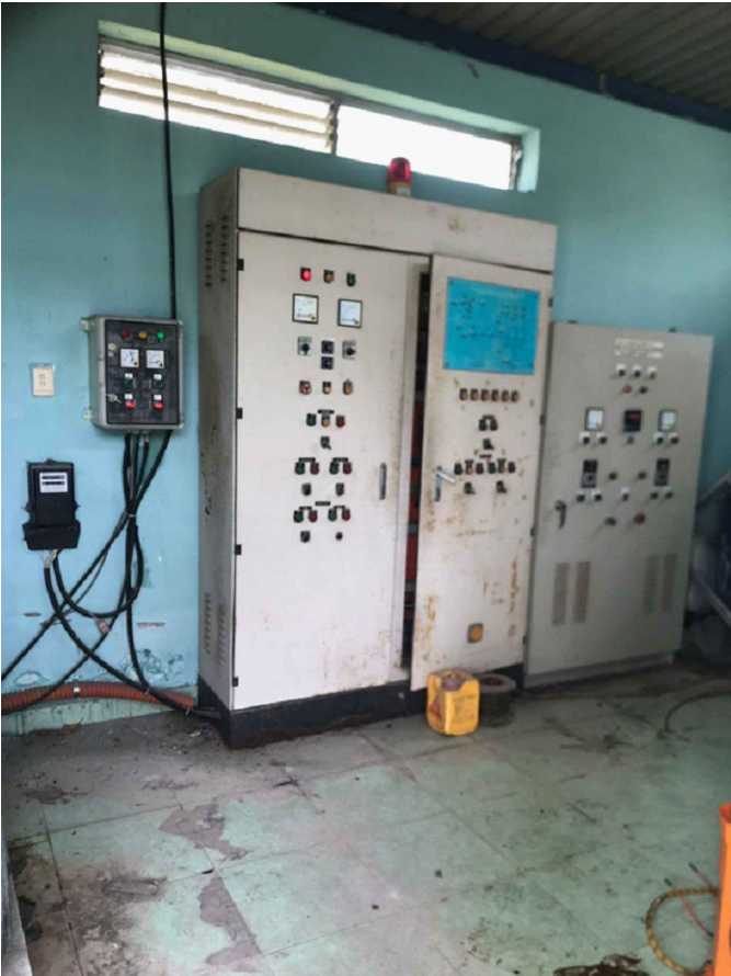
TỦ ĐIỆN ĐIỀU KHIỂN MÁY BƠM
