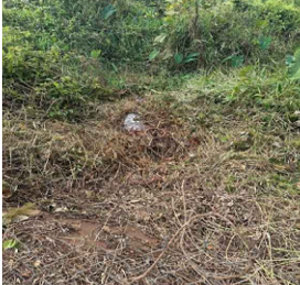
Hố chứa van bị lấp, tay quay cửa van gỉ sét và có rỉ nước ra bên trên
