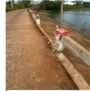
Lan can mặt đập bị hư hỏng, gây mất an toàn giao thông
