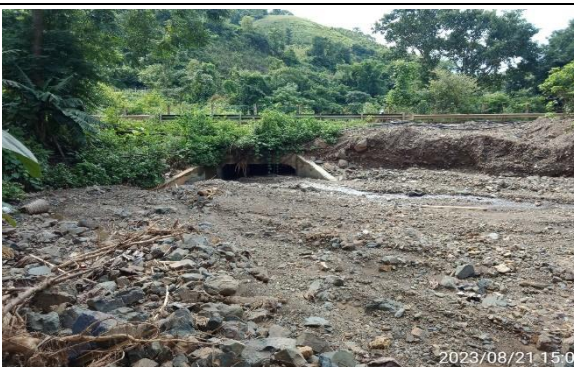
Ảnh 23. Đất đá bồi lấp hố thu cống, mặt đường tại km3+420m_NP1, ngày 21/8/2023
