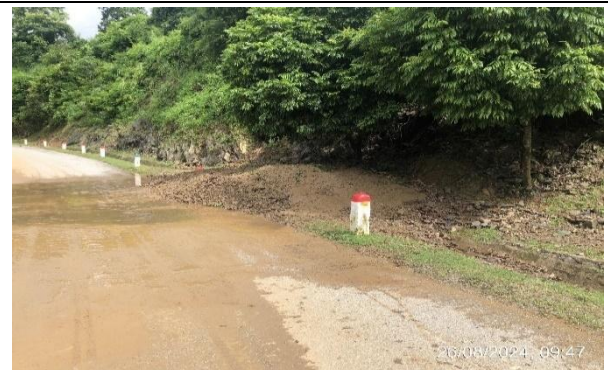
Ảnh 55. Đất đá sạt sụt bồi lấp rãnh thoát nước, mặt đường khu vực km1+190m_NT1
