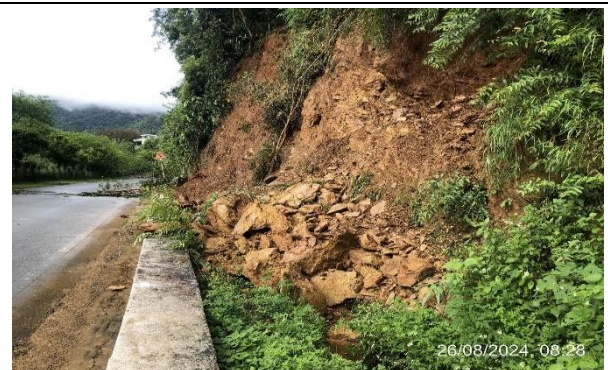
Ảnh 57. Đất đá bồi lấp kênh thoát nước đoạn km3+500m_NT1
