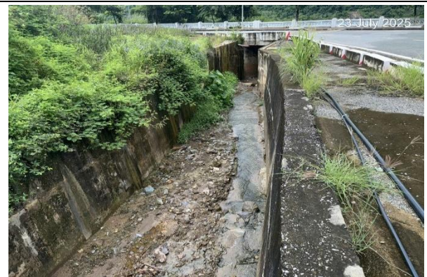
Ảnh 51. Đất đá bồi lấp kênh, cống thoát nước tuyến đường NT1_VT, ngày 8/7/2025
