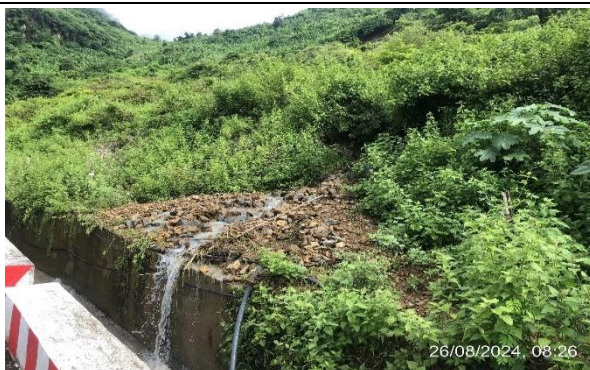
Ảnh 56. Đất đá bồi lấp kênh thoát nước đoạn km3+50m_NT1
