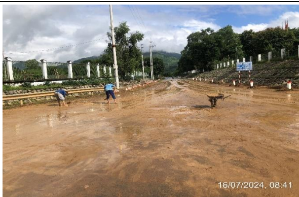
Ảnh 52. Đất đá bồi lấp rãnh thoát nước, mặt đường khu vực km0+00m_NT1
