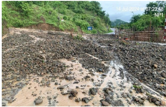
Ảnh 26. Đất đá bồi lấp hố thu cống, mặt đường tại km0+50m_NP1, ngày 18/7/2024
