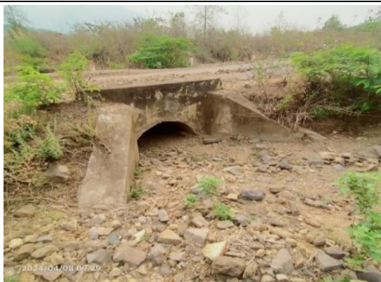
Ảnh 64. Đất đá bồi lấp trong cống qua đường
