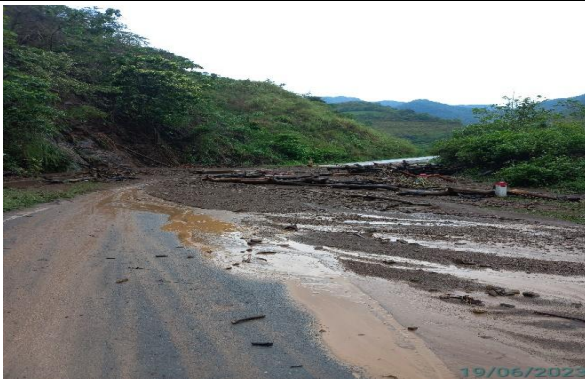
Ảnh 11. Đất đá bồi lấp mặt đường tại km2+750m_NP1, ngày 19/6/2023
