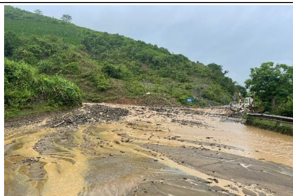
Ảnh 20. Đất đá bồi lấp hố thu cống, mặt đường tại km0+50m_NP1, ngày 21/8/2023
