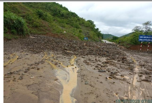
Ảnh 15. Đất đá bồi lấp hố thu cống, mặt đường tại km0+50m_NP1, ngày 26/7/2023
