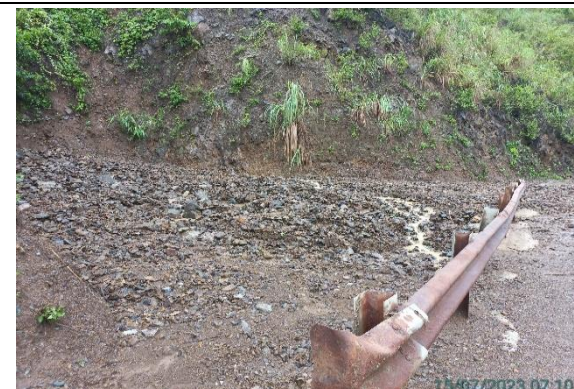
Ảnh 17. Đất đá bồi lấp hố thu, mặt đường tại km2+150m_NP1, ngày 26/7/2023
