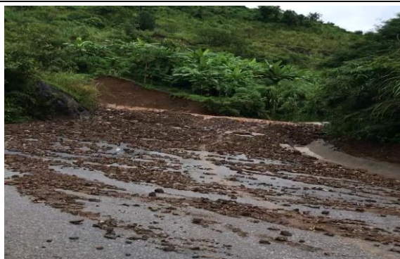
Ảnh 32. Đất đá bồi lấp hố thu cống, mặt đường km0+720m_NP1, ngày 23/8/2024
