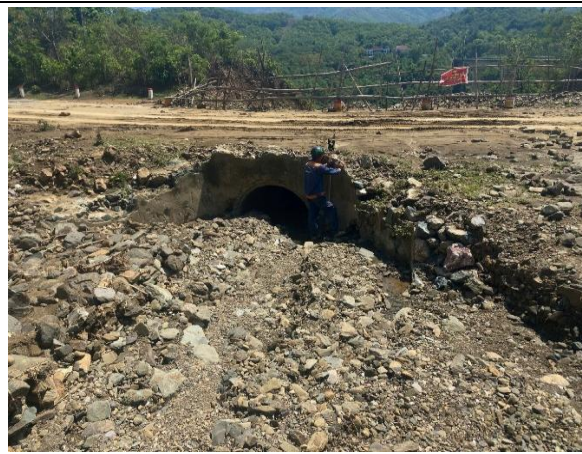
Ảnh 67. Đất đá bồi lấp trong cống thoát nước
