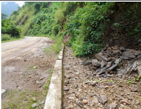
Ảnh 66. Đất đá bồi lấp trong rãnh thoát nước
