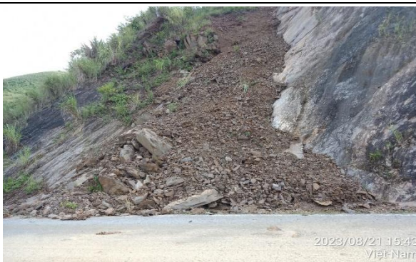
Ảnh 22. Đất đá bồi lấp mặt đường tại km0+870m_NP1, ngày 21/8/2023
