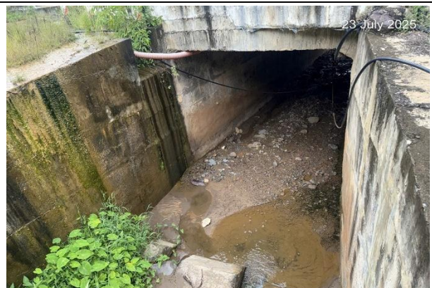
Ảnh 49. Đất đá bồi lấp kênh, cống thoát nước tuyến đường NT1_VT, ngày 8/7/2025
