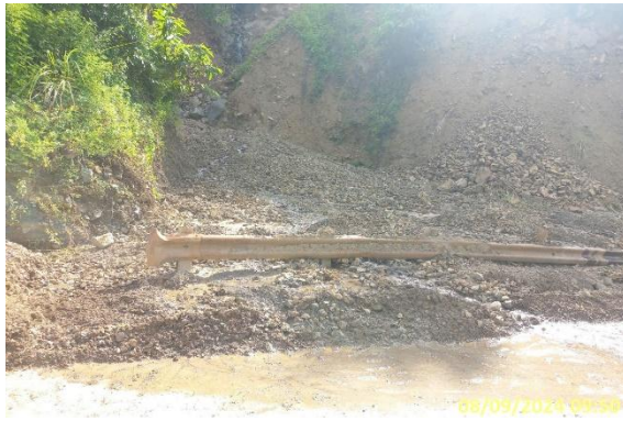
Ảnh 34. Đất đá bồi lấp hồ thu công, mặt đường km0+459m_NP1, ngày 12/9/2024
