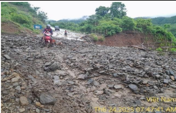
Ảnh 40. Đất đá bồi lấp hồ thu, mặt đường tại km0+50m_NP1, ngày 8/7/2025
