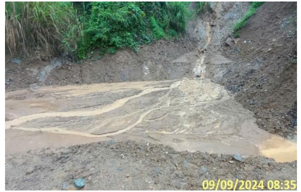
Ảnh 35. Đất đá bồi lấp hồ thu công, mặt đường km0+720m_NP1, ngày 12/9/2024
