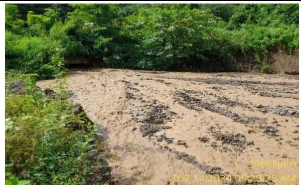
Ảnh 29. Đất đá bồi lấp mặt đường tại km3+420m_NP1, ngày 18/7/2024
