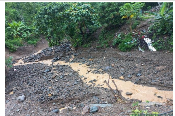
Ảnh 18. Đất đá bồi lấp hố thu cống tại km3+420m_NP1, ngày 26/7/2023
