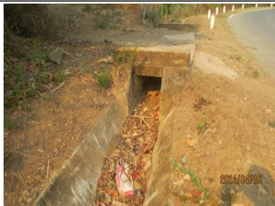
Ảnh 65. Đất đá bồi lấp trong cống rãnh dọc
