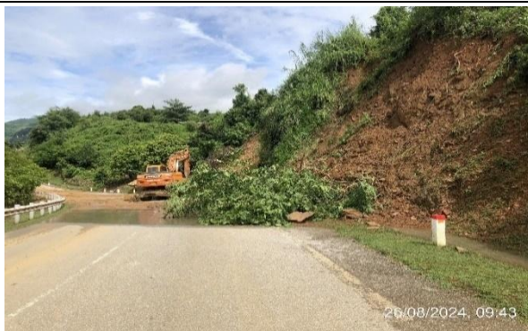
Ảnh 54. Đất đá sạt sụt bồi lấp rãnh thoát nước, mặt đường khu vực km0+850m_NT1
