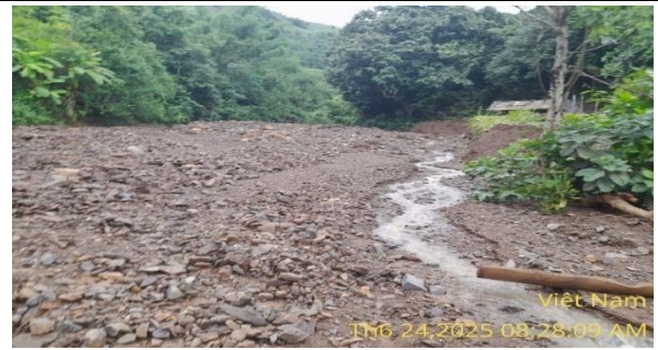
Ảnh 43. Đất đá bồi lấp hồ thu, mặt đường tại km3+420m_NP1, ngày 8/7/2025
