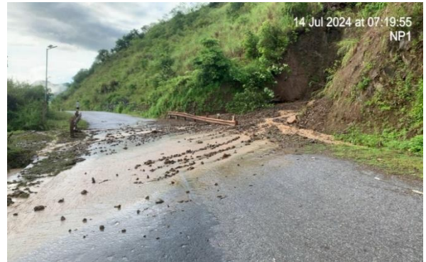
Ảnh 27. Đất đá bồi lấp hố thu cống, mặt đường tại km0+459m_NP1, ngày 18/7/2024
