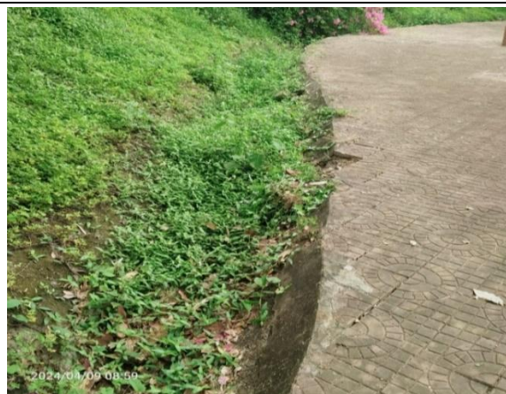
Ảnh 62. Đất đá bồi lấp trong rãnh thoát nước
