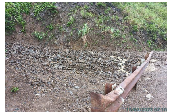
Ảnh 16. Đất đá bồi lấp hố thu cống, mặt đường tại km0+459m_NP1, ngày 26/7/2023
