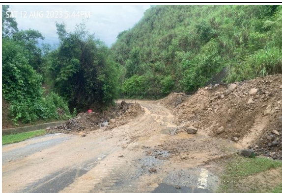
Ảnh 21. Đất đá bồi lấp mặt đường tại km0+767m_NP1, ngày 21/8/2023
