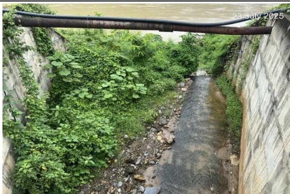
Ảnh 50. Đất đá bồi lấp kênh, cống thoát nước tuyến đường NT1_VT, ngày 8/7/2025
