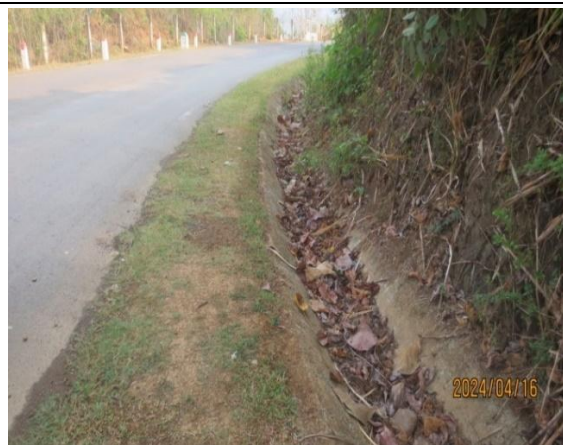
Ảnh 63. Đất đá bồi lấp trong rãnh thoát nước
