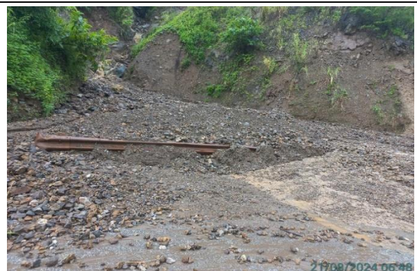
Ảnh 31. Đất đá bồi lấp hố thu, cống và mặt đường tại km0+459_NP1, ngày 23/8/2024
