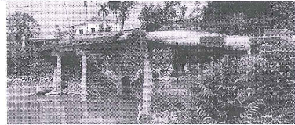
Hình 1: Hiện trạng cầu cũ
