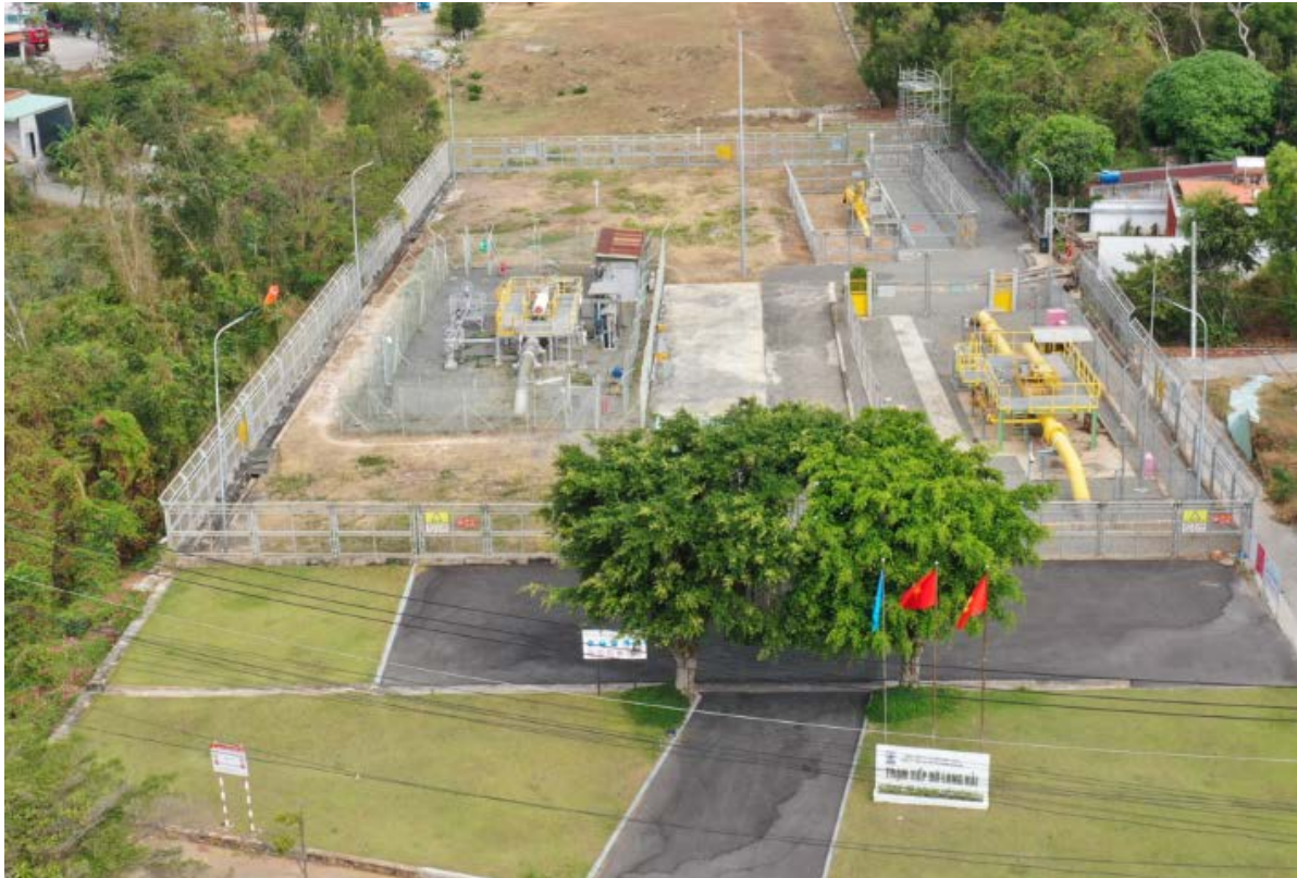
Hình 3. Trạm van Long Hải
